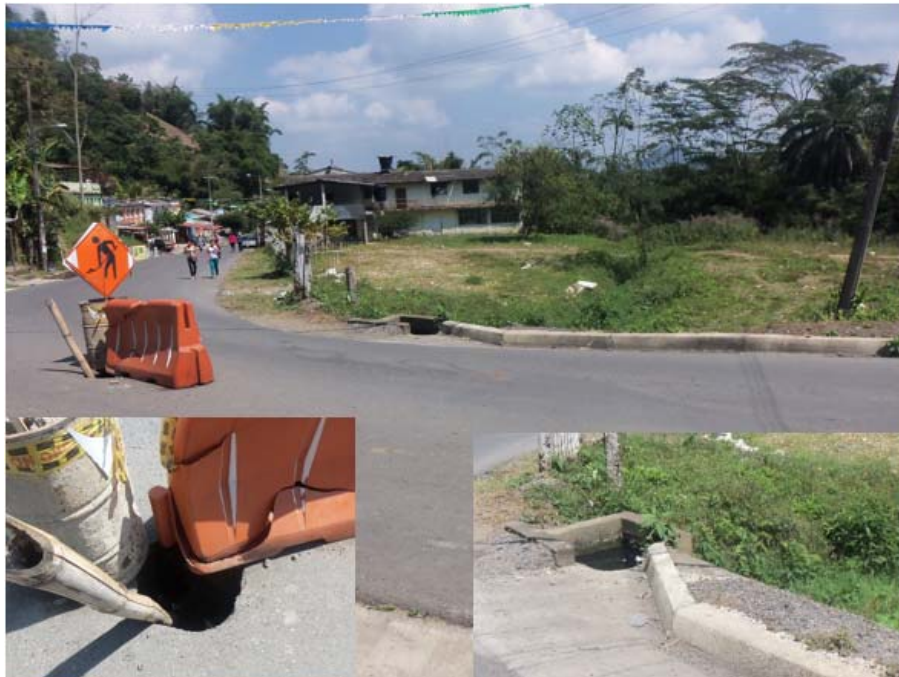
Figura 16. Afectaciones sobre la vía, enero 2016.
