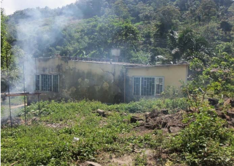
Figura 11. Daños en infraestructura del centro de salud.
