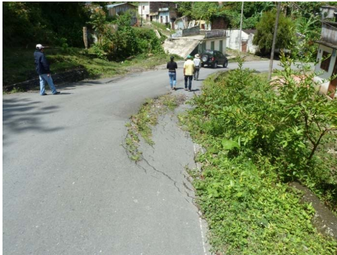
Figura 13. Afectaciones sobre la vía, septiembre 2012.
