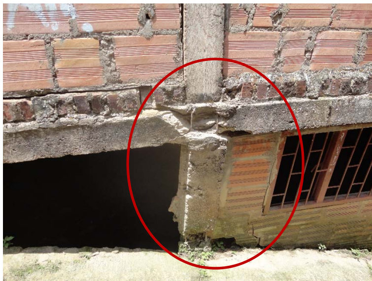
Figura 10. Falla estructural nodo columna- placa
