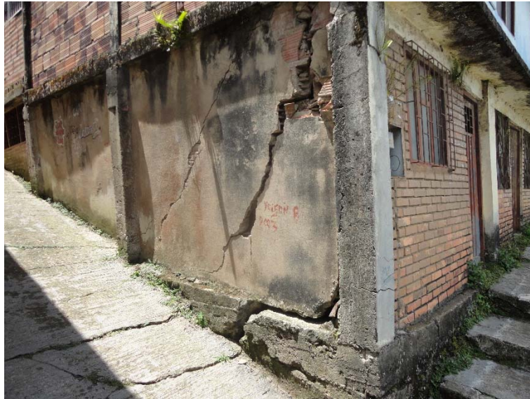
Figura 9. Falla estructural vivienda localizada sector central.
