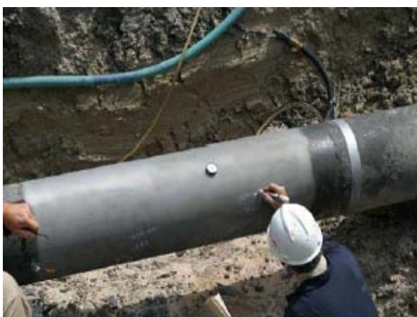
Ilustración 27 Identificación del daño
