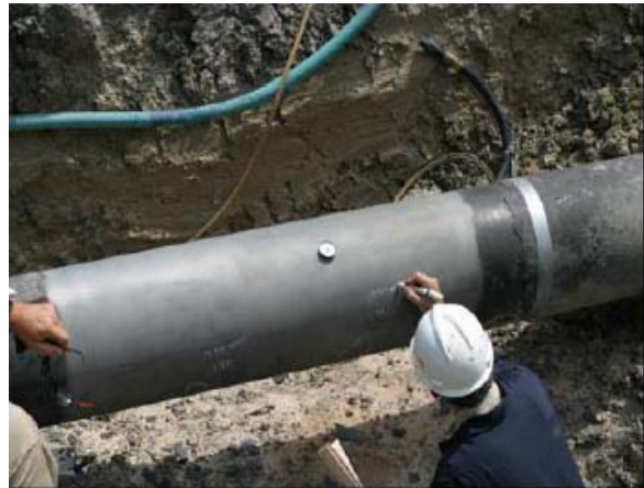
Ilustración 2 Identificación del Daño
