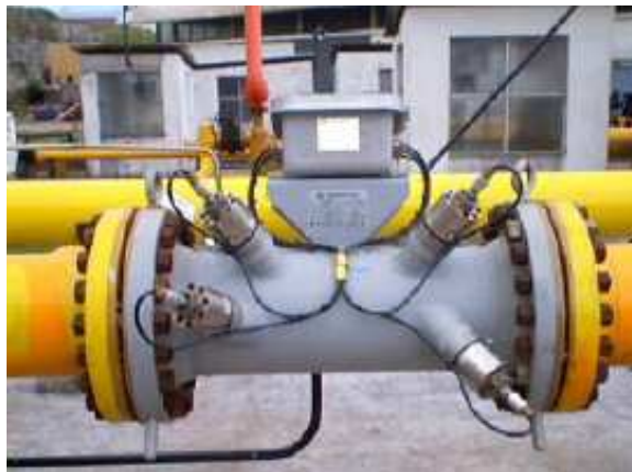
Figura 13. Conexiones e instalación del Medidor Ultrasónico
