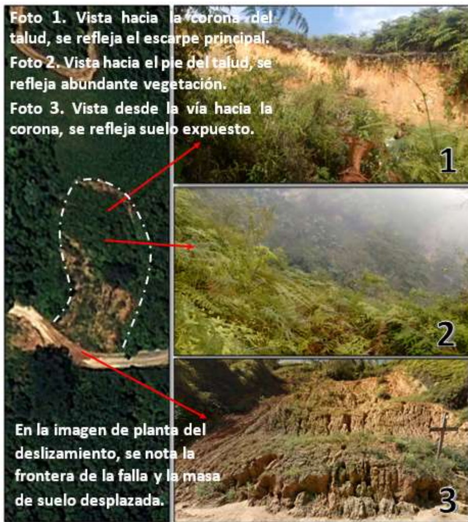
Figura 10. Estado del Talud en estudio.
