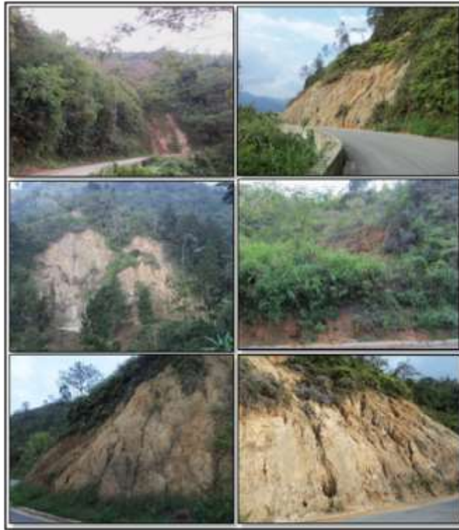
Figura 12. Deslizamientos aledaños al talud en estudio.
