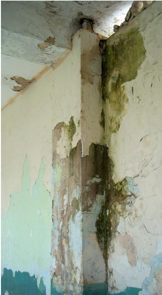
Figura 24. Deterioro y humedad en viga y columna.
