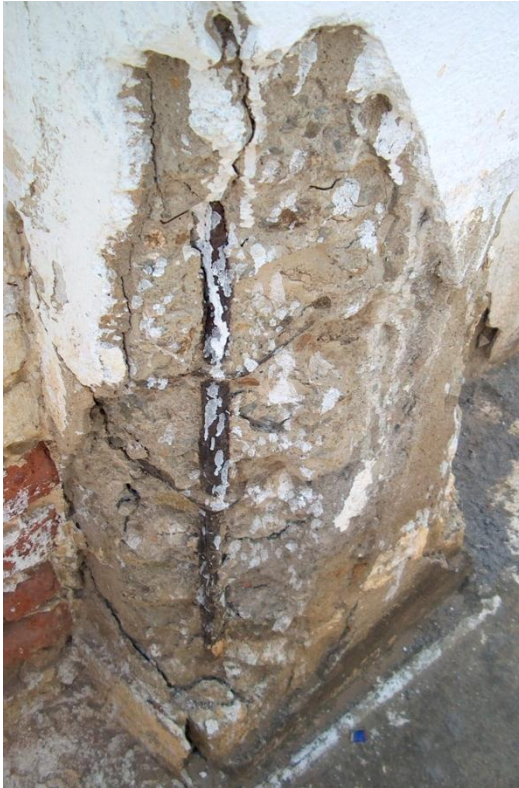
Figura 28. Columna con refuerzo expuesto.
