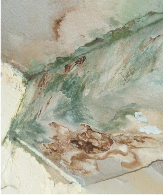
Figura 29. Humedad en viga y losa.
