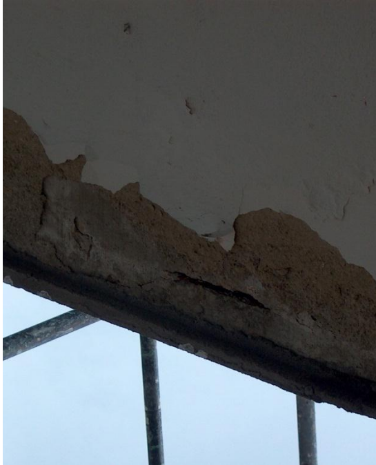
Figura 27. Deterioro en la losa.
