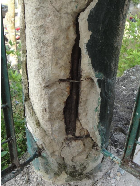
Figura 23. Columna muy deteriorada.
