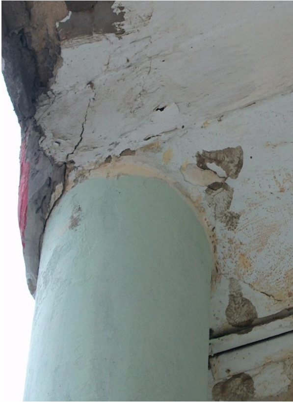
Figura 26. Fisuración en nodo.
