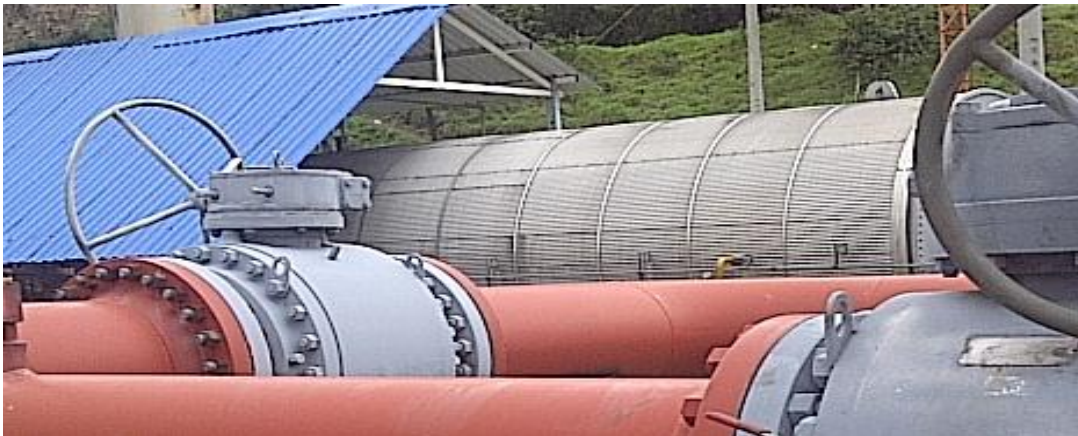
Figura 3.6. Intercambiador de calor de Gas Natural SA ESP.
