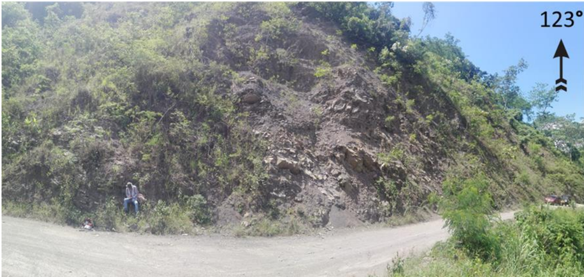
Figura 20. Fotografía de la estación CC8; sobre la vía a Bocas. Afloramiento de la Formación Bocas afectado por acción de la falla de Rionegro. Dado que la litología es predominantemente lodolita, y presenta un alto grado de meteorización mecánica y química, no se encontraron estrías.
