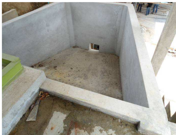
Fotografía 3. Ejemplo de una tolva
