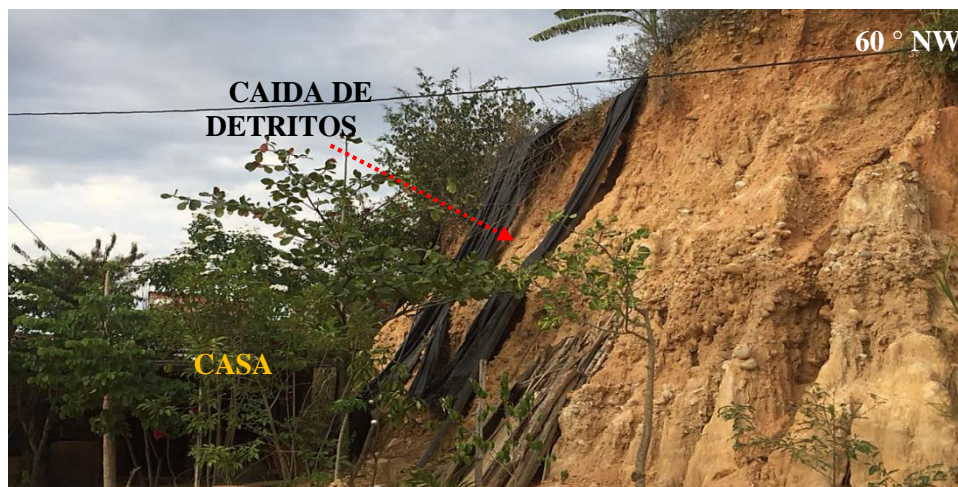
Figura 26. Vivienda hacia el Este del asentamiento, expuesta a caída de detritos.
