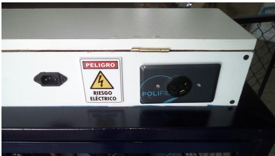
Figura 44. Panel de cableado con placa de seguridad
