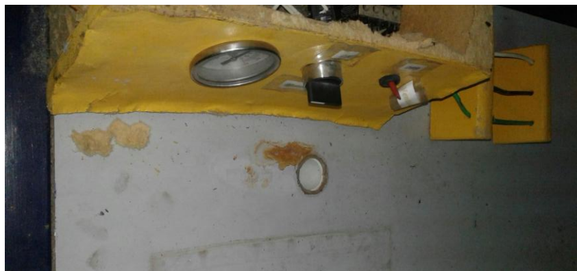
Figura 15. Panel de manejo del banco y estructura
