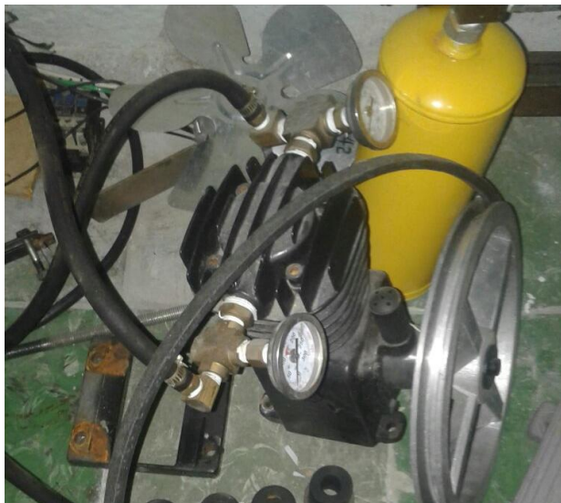
Figura 14. Medidores instalados sobre los compresores
