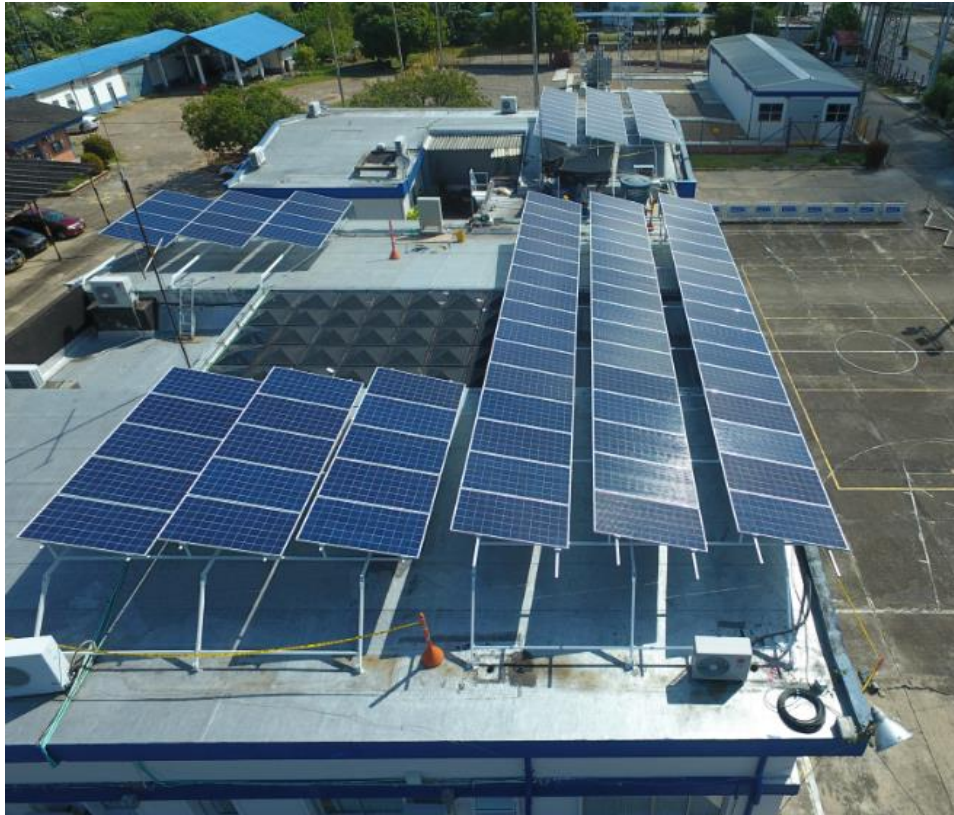
Figura 3. Vista desde el oeste del conjunto de paneles solares
