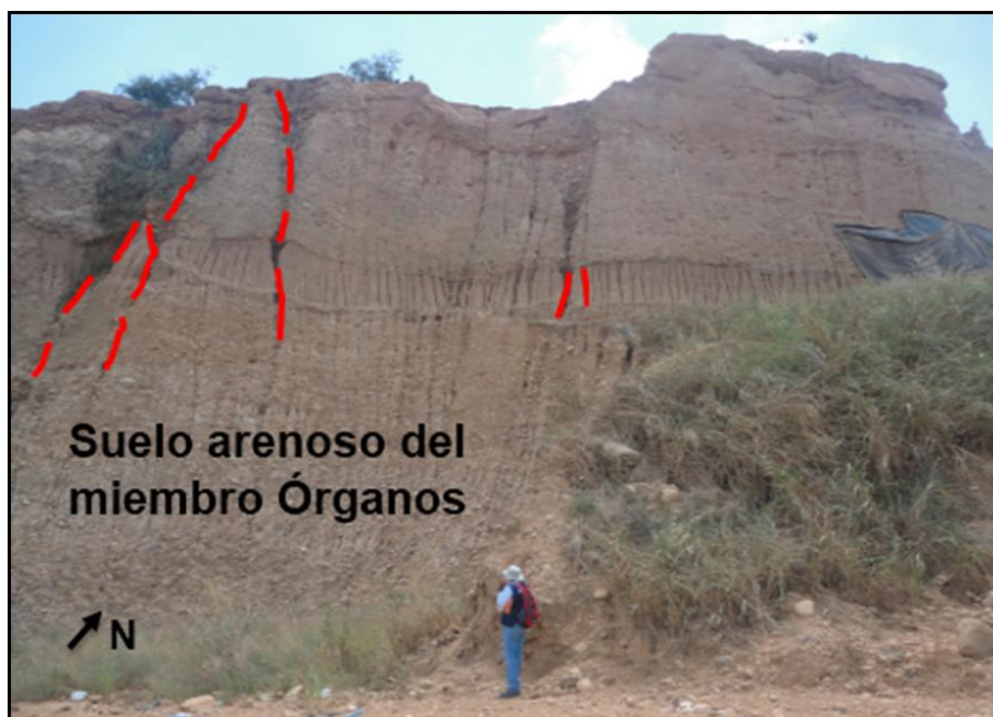
Figura 16. Evidencia de erosión laminar en el suelo arenoso del miembro Órganos, presentado zurcos y cárcavas de más de un metro de ancho y profundidad, mientras que de largo cubre todo el talud (aprox. 30 metros).
