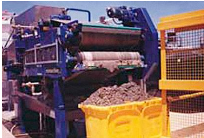
Fotografía 2 Unidad de DEWATERING
