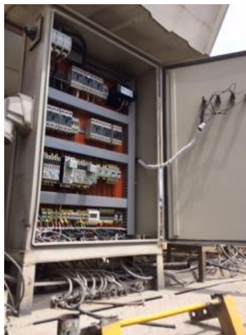
Figura 22. Tablero de control eléctrico
