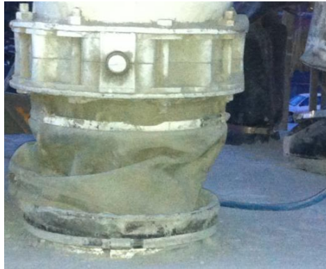
Figura 15. Válvula del silo de cemento
