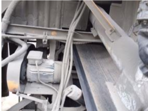
Figura 7. Motor banda transportadora
