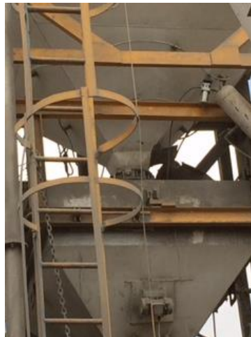
Figura 14. Báscula dosificadora de cemento y cementante
