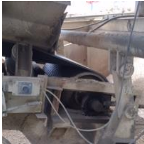
Figura 10. Tambor de cola de banda transportadora
