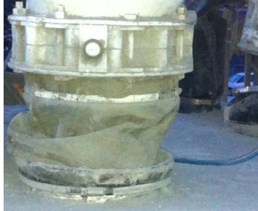
Figura 13. Válvula del silo de cemento
