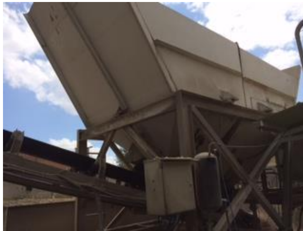
Figura 11. Tolva báscula dosificadora de arena y agregado
