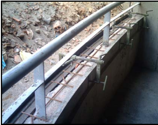
Figura N.º 33. Pasamanos del balcón soldado a los anclajes de 3/8"
