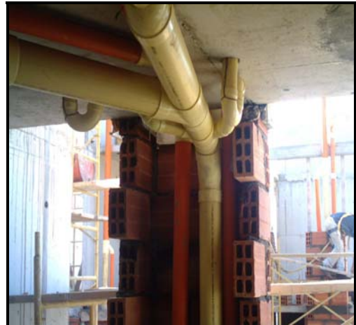
b. Tramo de desagües conectados al bajante dentro del buitrón.
