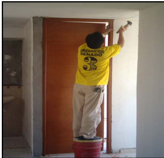
Figura N.º 32. Instalación del marco y la puerta de la alcoba principal.
