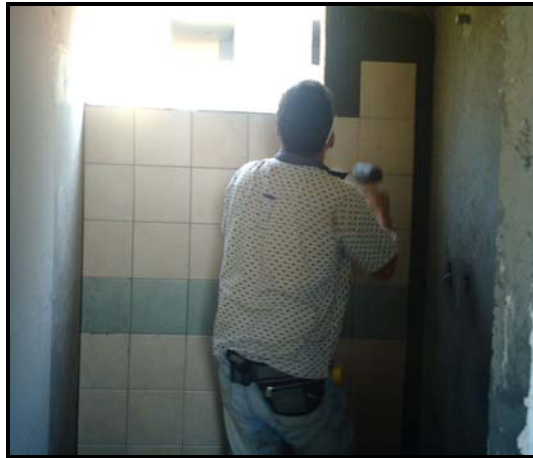
Figura N o 30. Pegue de losas del enchape en baño principal.
