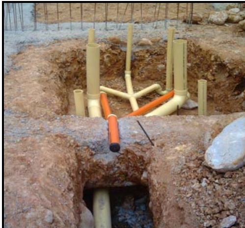
a. Desagües baños apto 1 er piso.
