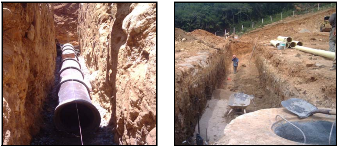
Figura N.º 15. Instalación de tubería de gres con cama de agregado y tubería Novafort con cama de arena gruesa.
