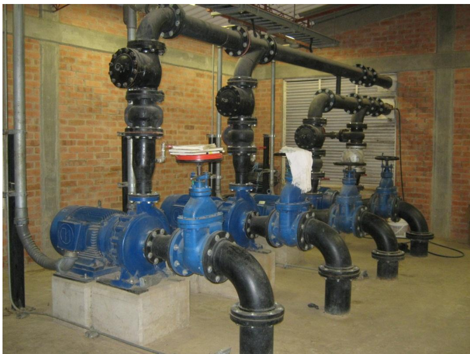
Fotografía 7. Sala de Bombas del Acueducto del Municipio de Trinidad.
