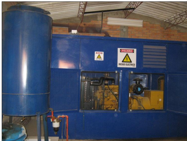
Fotografía 5. Planta de ACPM (OLYMPIAM. CATERPILLAR OVERSEAS S.A, 76 ROUTE DE FRONTENEX BP 456 1211 GENEVA 6 SWITZERLAND) que utiliza el Municipio de Trinidad.
