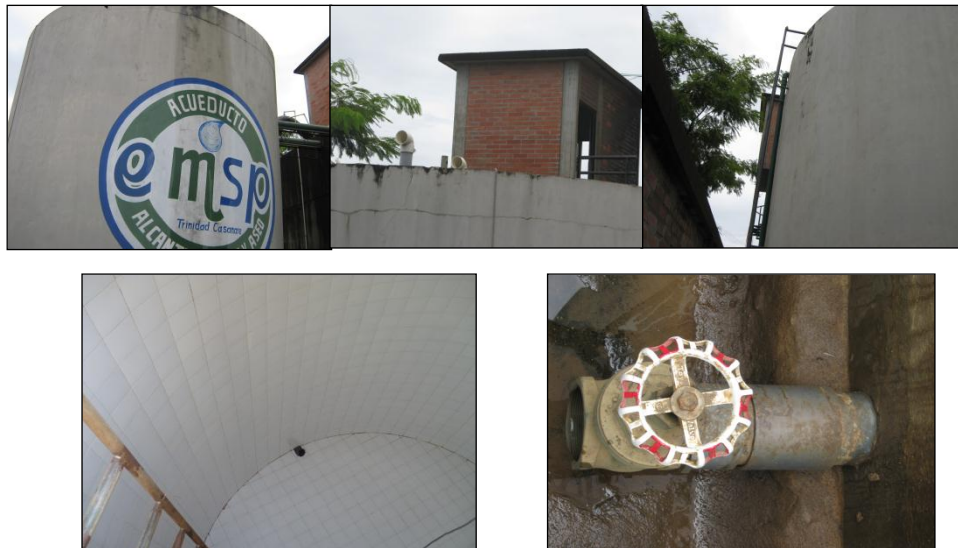
Fotografía 8. Primer Tanque Superficial.
