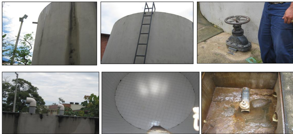
Fotografía 9. Segundo Tanque Superficial.
