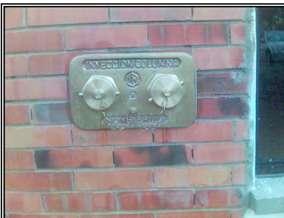
Figura 72. Siamesas contra incendio.
