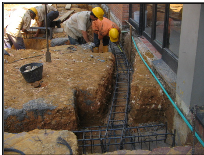
Figura 51. Desviación en zapata Z-1, febrero de 2006.
