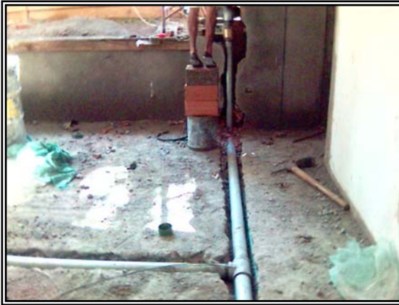
Figura 70. Tubería contra incendio.
