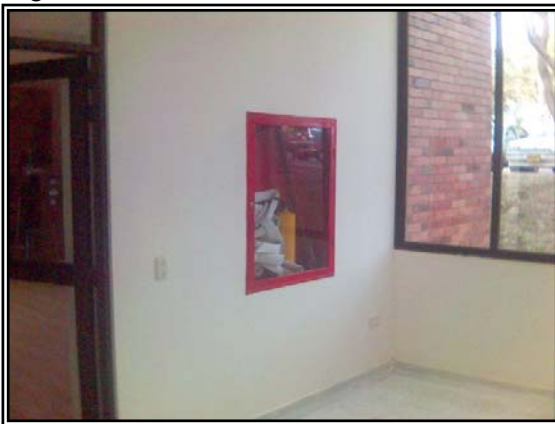
Figura 71. Gabinete contra incendio.
