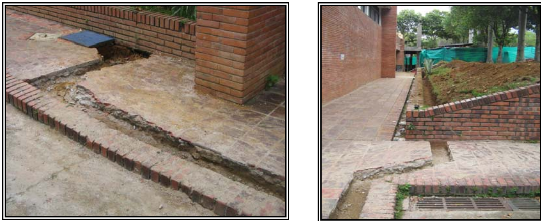
Figura 69. Recorrido del punto de acometida, Febrero de 2006.
