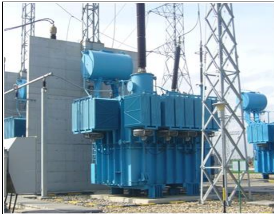
Ilustración 5 Autotransformador de Potencia Subestación Bacata
