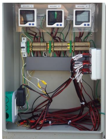
a. Tablero DC (AcuDC 243 y protecciones eléctricas).
