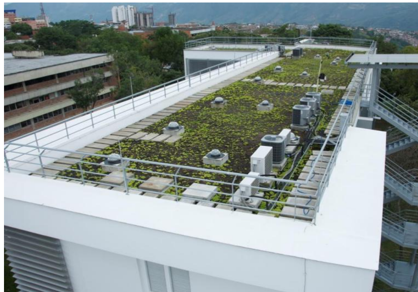
Figura 10. Techo verde del Edificio de Ingeniería Eléctrica.
