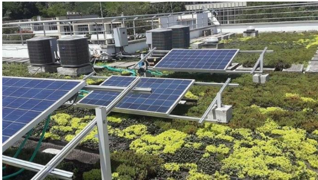
Figura 22. Variación de la altura de instalación (Edificio de Ingeniería Eléctrica).
