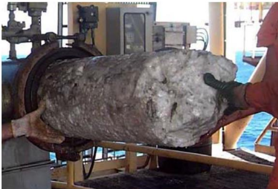
Figura 2. Hidrato sólido bloqueando tubería.
