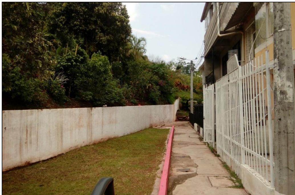
Figura 93. Humedades presentes en el muro de la base del talud, a la derecha de la casa 10 en la manzana L del barrio Bariloche II. Foto tomada en 07/Abril/2019.
