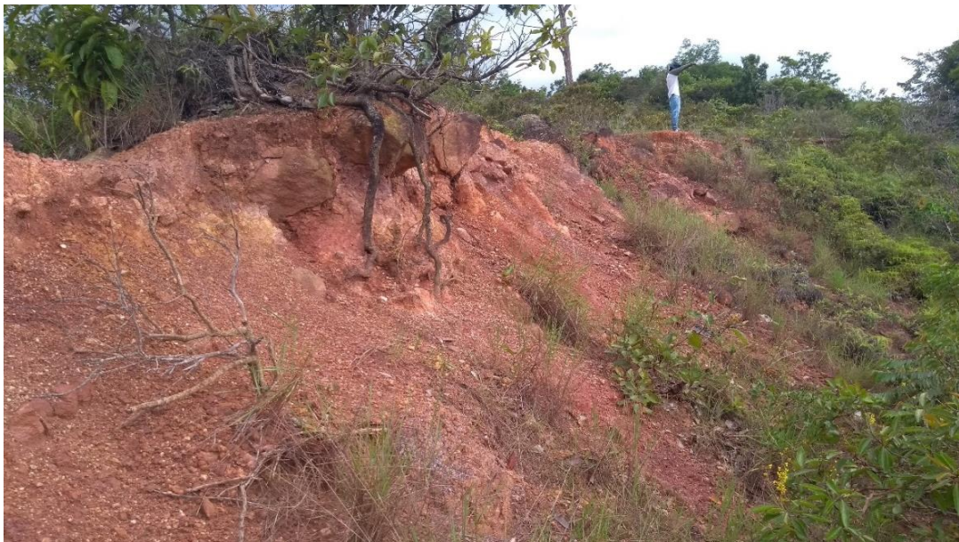
Figura 54. Escarpe principal que corresponde al borde de la UGI llamada Strcc; ella limita al norte con de la unidad geomorfológica Laderas cóncavas (Dlc). Foto tomada en 01/Junio/2019.
