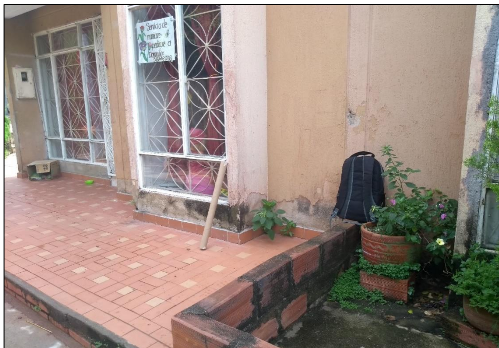
Figura 96. Humedades en el zócalo de la casa 7 en la Manzana O del barrio Bariloche II. Foto tomada en 01/Junio/2019.
