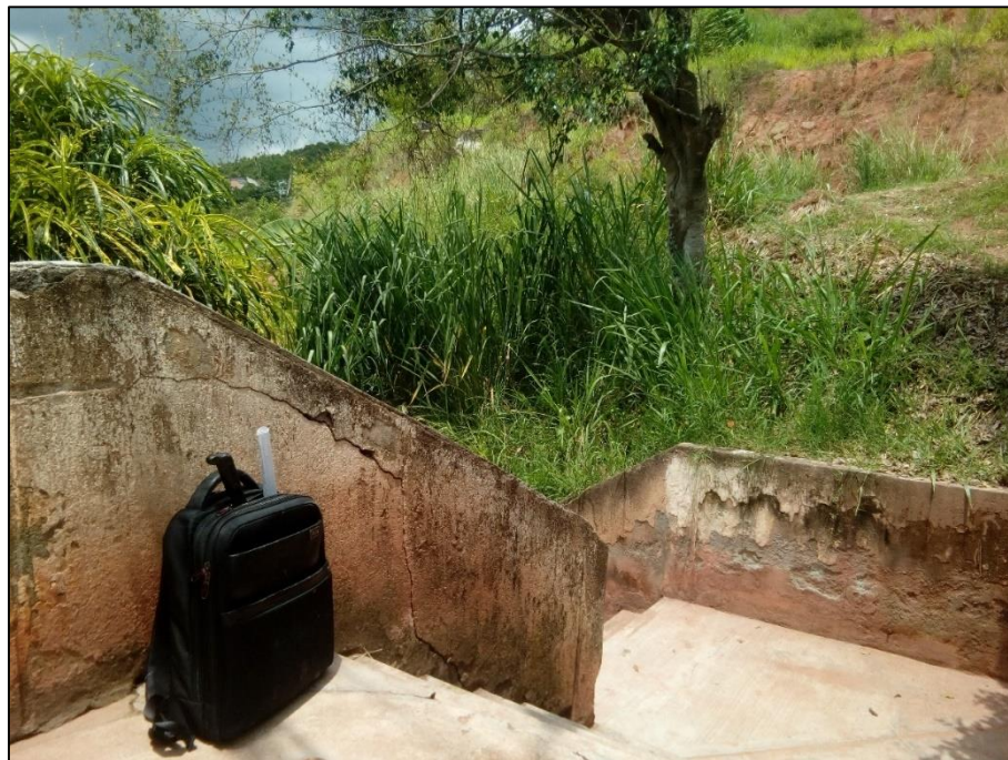
Figura 95. Mampostería de escaleras y confinamiento de zonas verdes, deterioradas por la humedad y falta de mantenimiento. Foto tomada el 25 de mayo de 2019.
