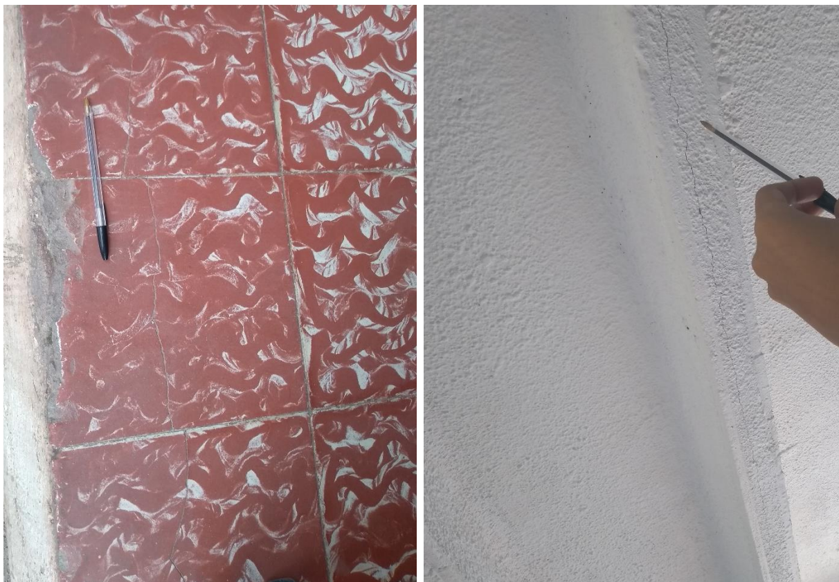
Figura 119 y 120. Fisuras presentes en pisos y vigas.
