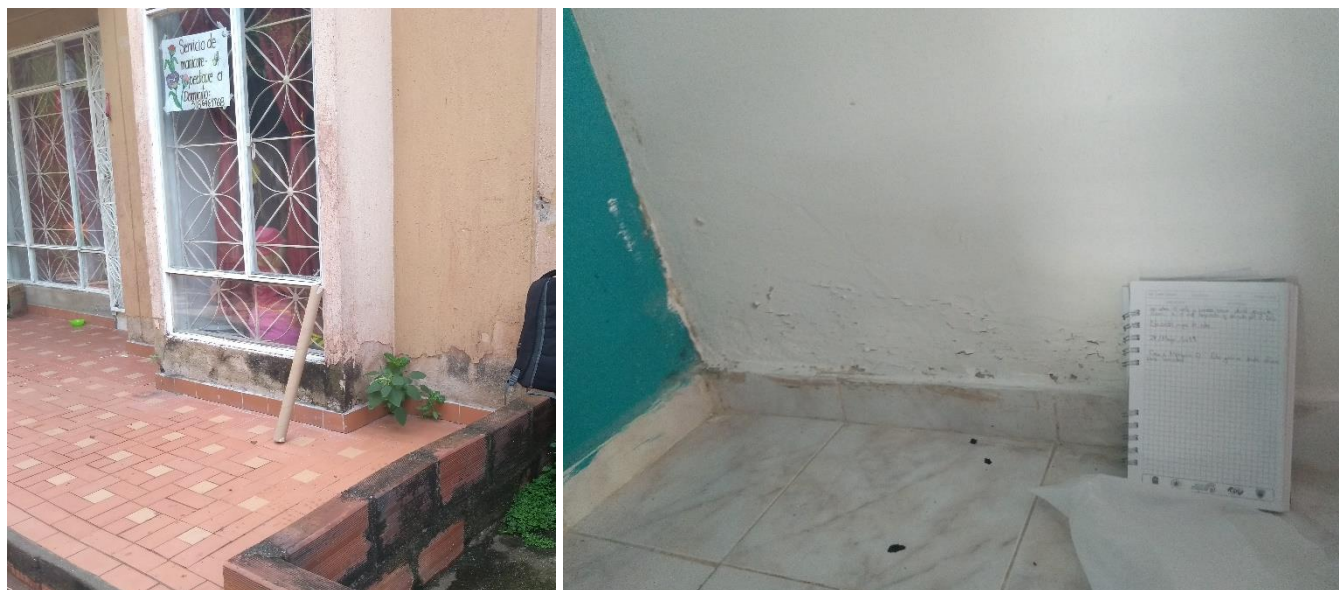
Figura 121. Humedades en fachadas y muros de las viviendas examinadas
