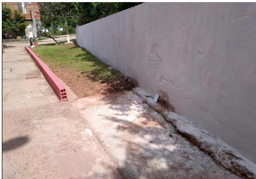
Figura 94. Detalle de la zona con goteos de aguas, en la pata del muro, cerca de la libreta (al centro). Foto tomada en 23/Mayo/2019.
