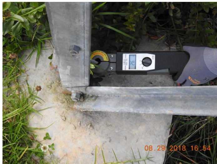
Figura 15. Medición de sistema de puesta a tierra.
