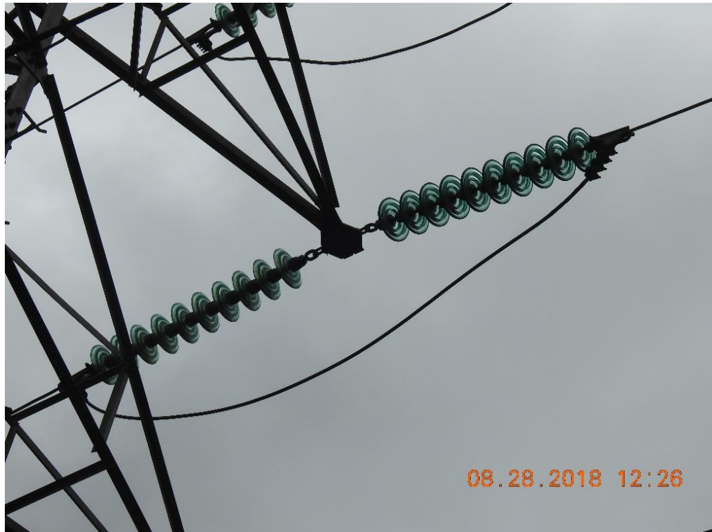
Figura 9. Aisladores de vidrio.
