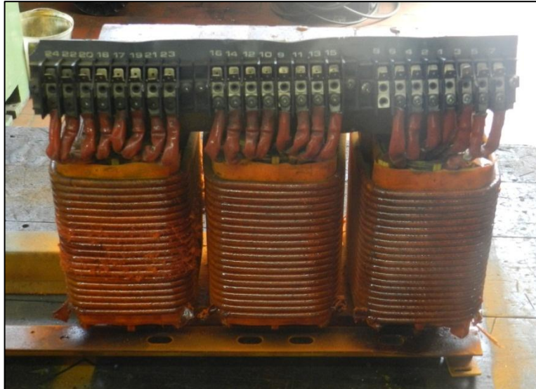
Figura B.1 Transformador trifásico cara posterior.
