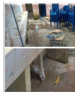
Fugas de agua
