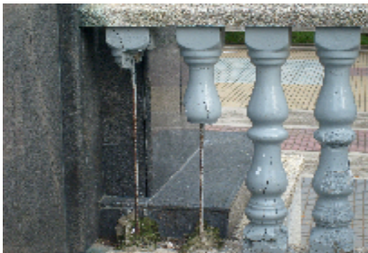
Fig. 19 El Parque Bolívar: averías en el monumento central
