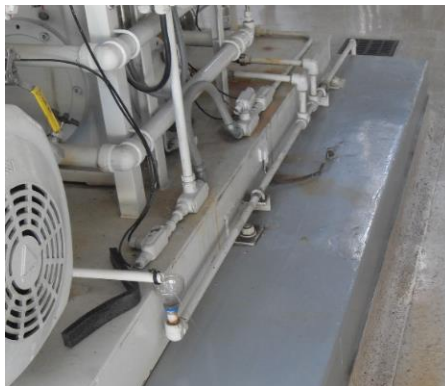
Figura 47. Drenaje de la trampa de humedad.
