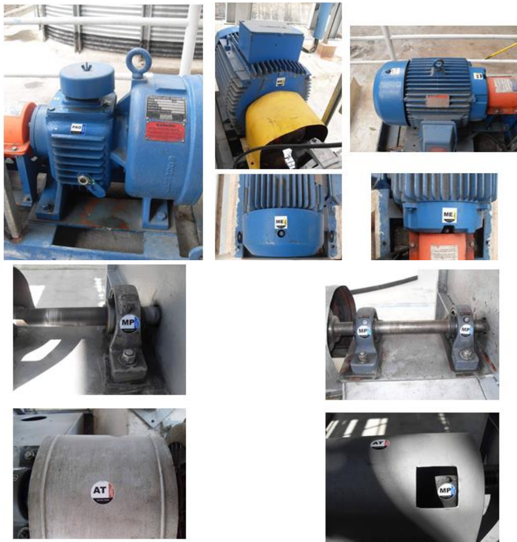
Figura 58. Demarcación tipo de lubricante.
