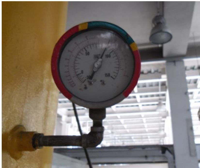
Figura 73. Manómetro tanque pulmón.
