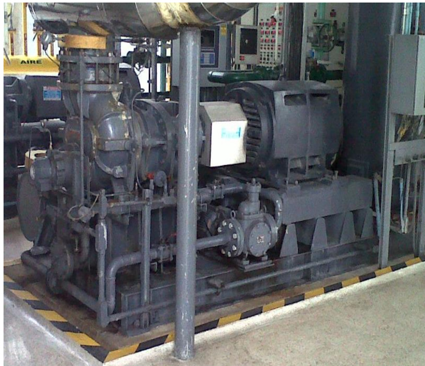
Figura 32. Compresor de amoniaco 2.
