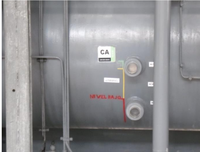
Figura 72. Indicador visual de nivel tanque de compresor amoniaco.
