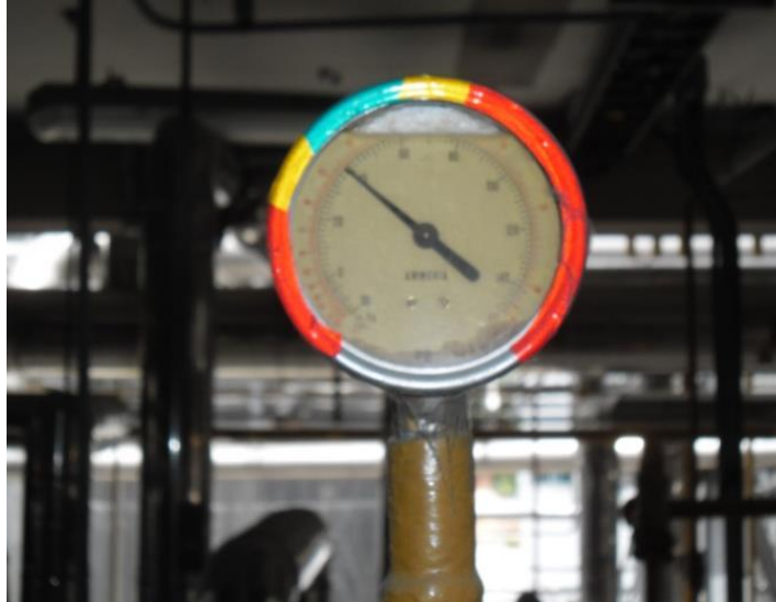
Figura 70. Manómetro tanque de baja sistema de refrigeración.
