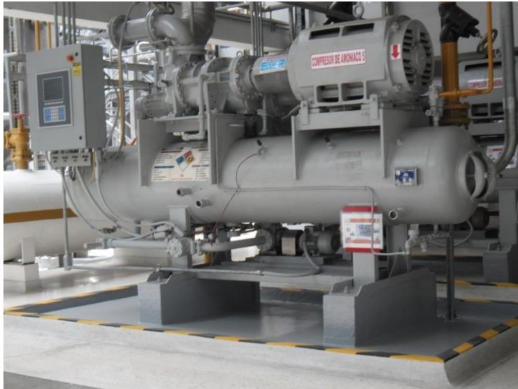
Figura 71. Compresor de amoniaco debidamente señalado.
