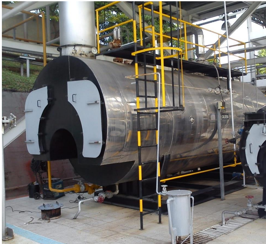
Figura 3. Caldera en Mantenimiento.
