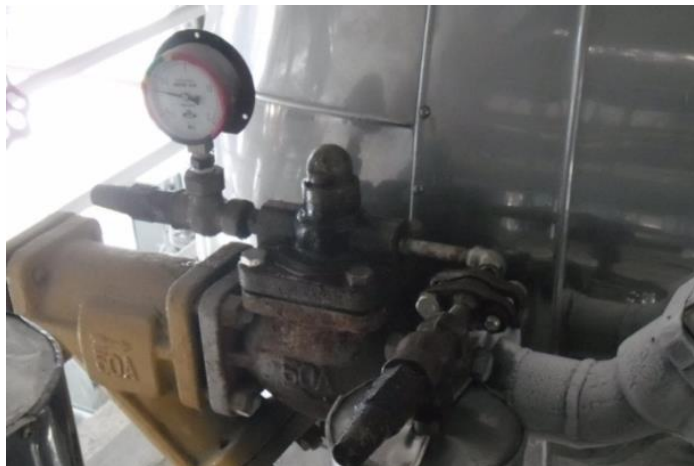
Figura 69. Válvula de expansión sistema de refrigeración.
