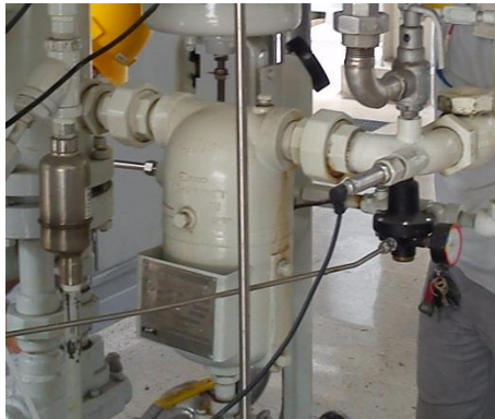
Figura 46. Trampa de humedad.
