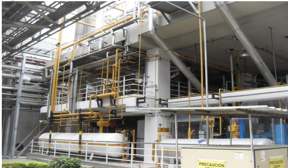
Figura 10. Sistema de refrigeración.
