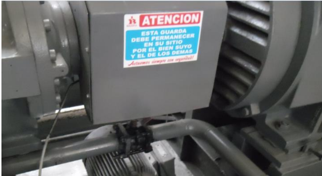
Figura 30. Indicación de seguridad.
