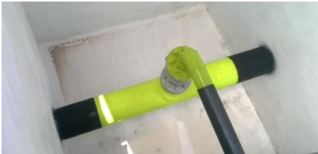
Figura 35. Tuberías y accesorios con pintura anticorrosiva.
