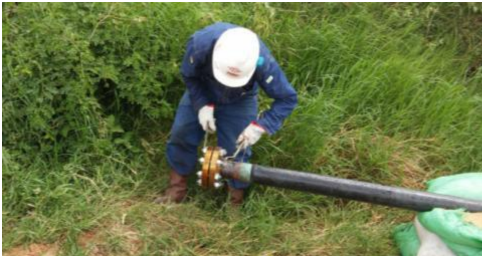
Figura 51. Cierre al final de la tubería con bridas.
