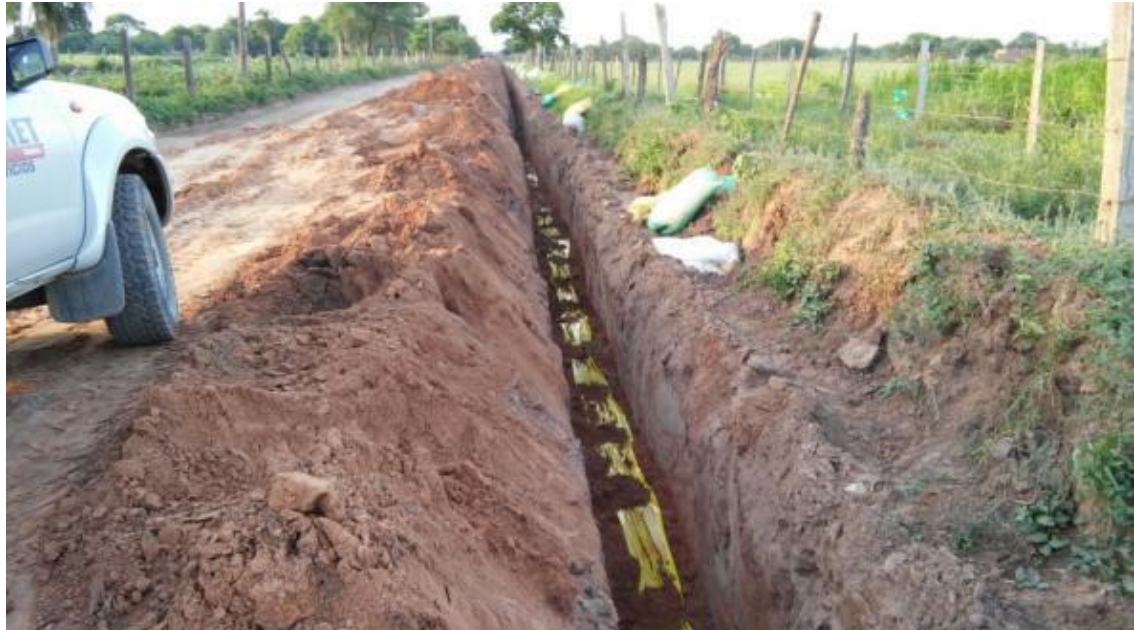
Figura 31. Cinta de seguridad encima de la tubería enterrada.
