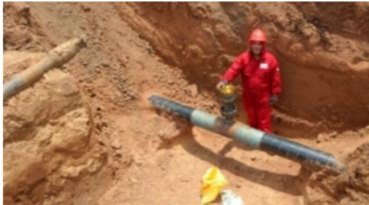
Figura 2. Conexión hot tap para una línea de 10" con una de 3".
