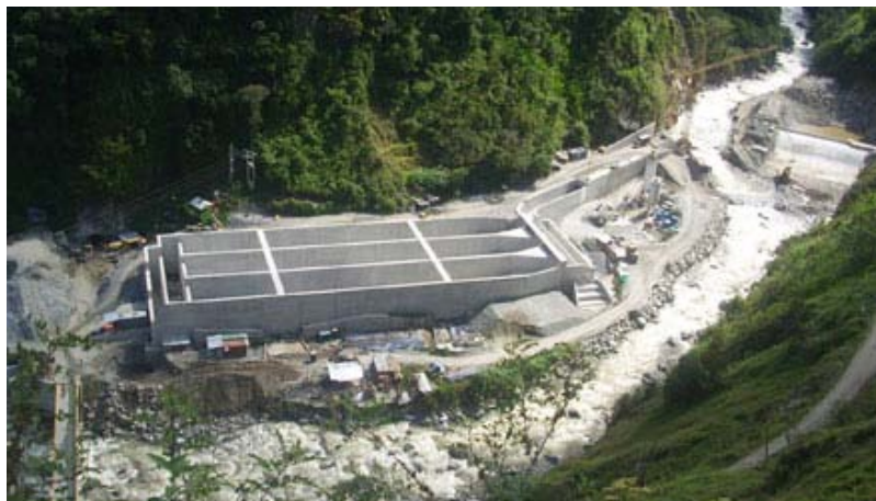
Figura 6. Proyecto Hidroeléctrico Amoyá
