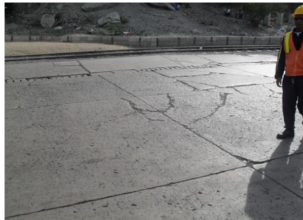
Figura 34. Grietas de Esquina
