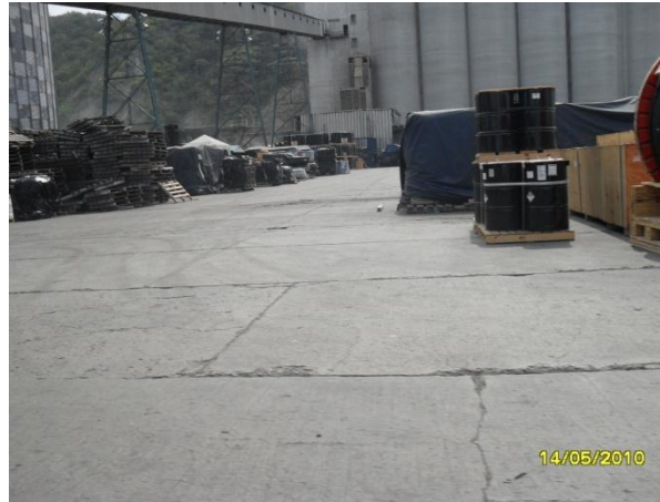
Figura 35. Desportillamiento de Juntas
