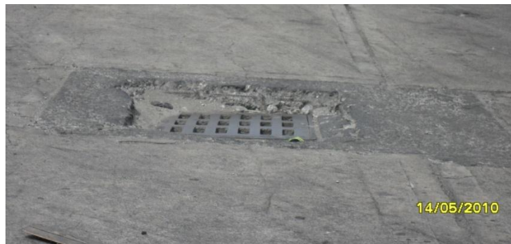
Figura 30. Grieta en pozos de alcantarillados
