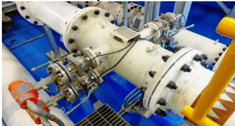
Figura 29. Medidor de flujo FIT-722 línea de venteo. ECGSB
