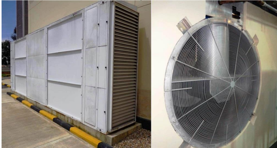
Figura 50. Sistema de ventilación forzada (Izq. Filtros y atenuador; Der. Ventilador), ECGSB.
