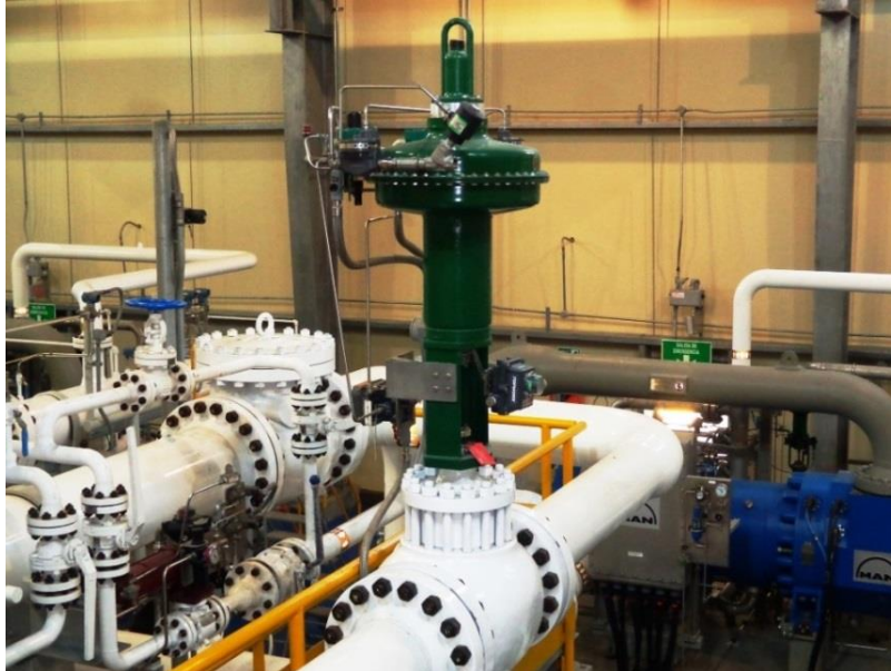
Figura 14. Válvula de recirculación (Antisurge) ECGSB.
