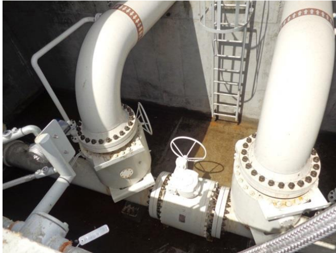
Figura 2. Manifold de válvulas de corte bunker ECGSB.
