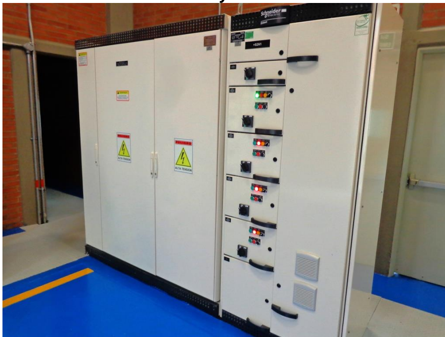
Figura 41. Tablero distribución 208 V y Transferencia Eléctrica CCM, ECGSB.
