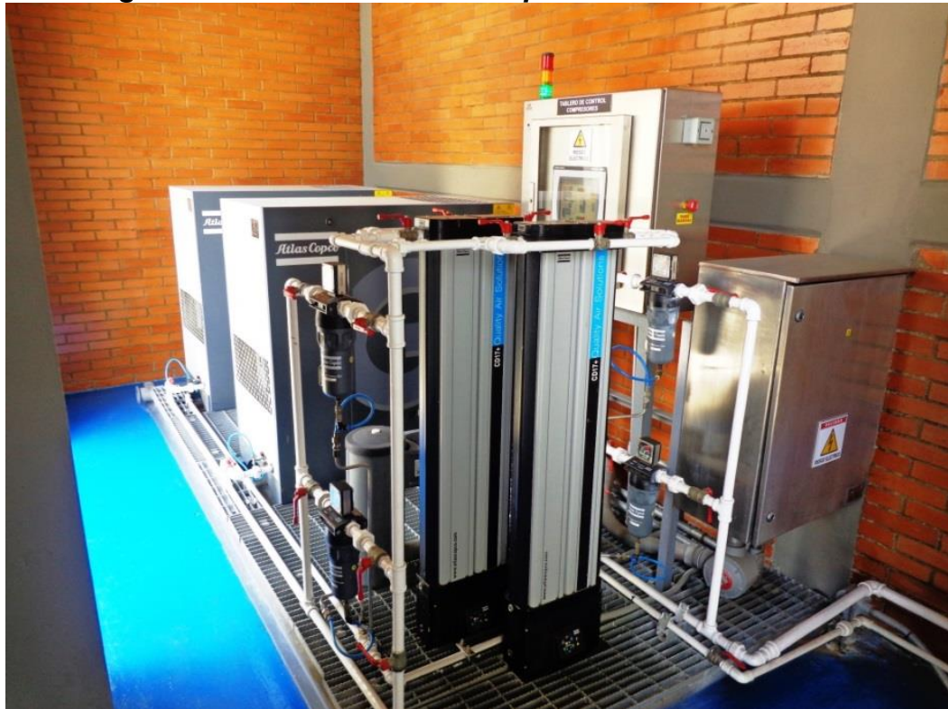
Figura 47. Skid sistema de compresores de aire ECGSB.
