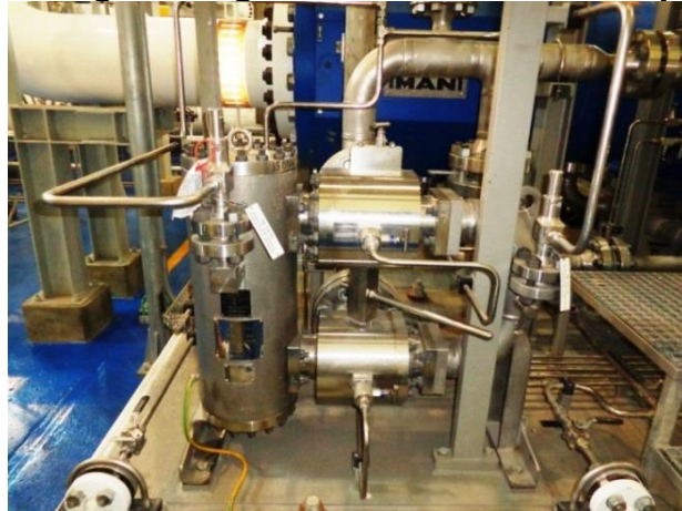
Figura 15. Filtro de gas refrigerante unidades de compresión ECGSB.
