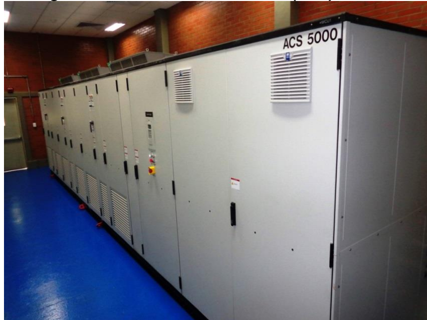
Figura 17. Variador de frecuencia (VFD) ECGSB.
