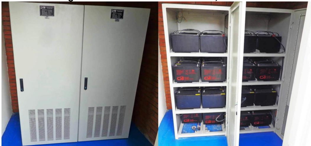
Figura 43. Rack de baterías UPS 's, ECGSB.
