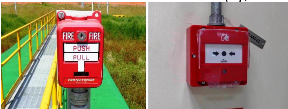
Figura 35. Estaciones manuales de activación ECGSB. (Izq., MAC. Der. EMA)
