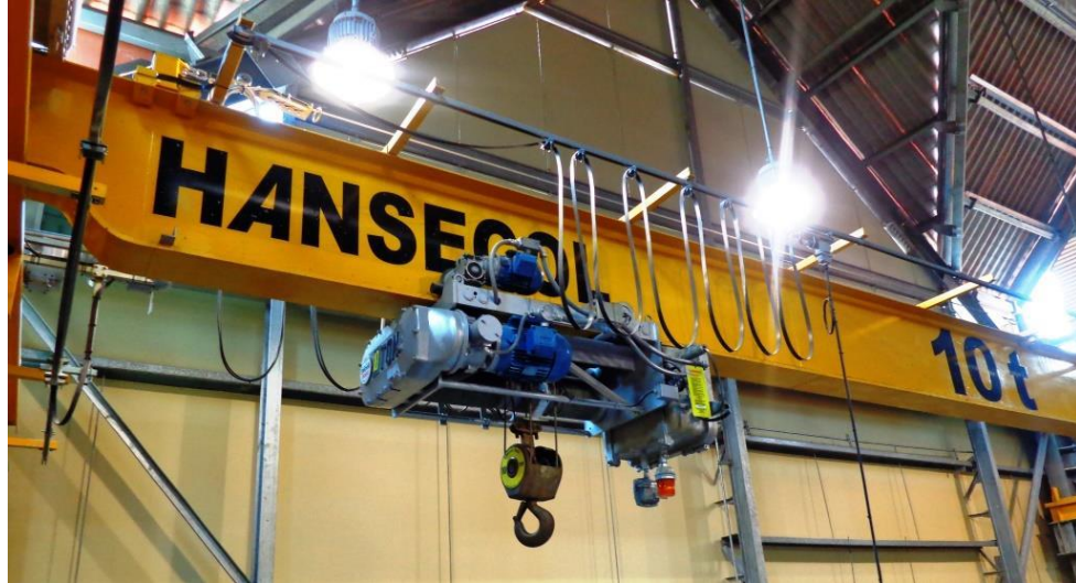
Figura 51. Puente grúa, ECGSB.
