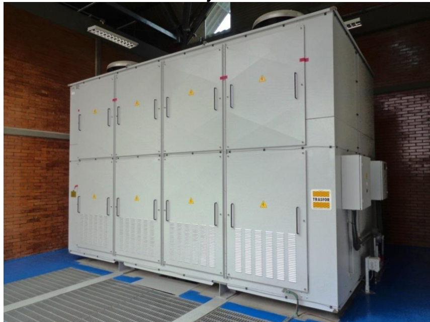
Figura 39. Transformador de voltaje multidevanado SB-TR-101 ECGSB.
