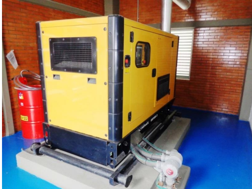
Figura 45. Generador eléctrico SB-GE-01, ECGSB.
