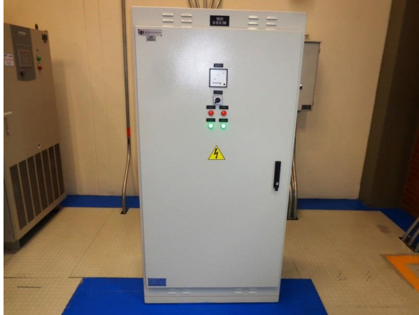
Figura 44. Tablero de cargas reguladas SB-TCR-01, ECGSB.
