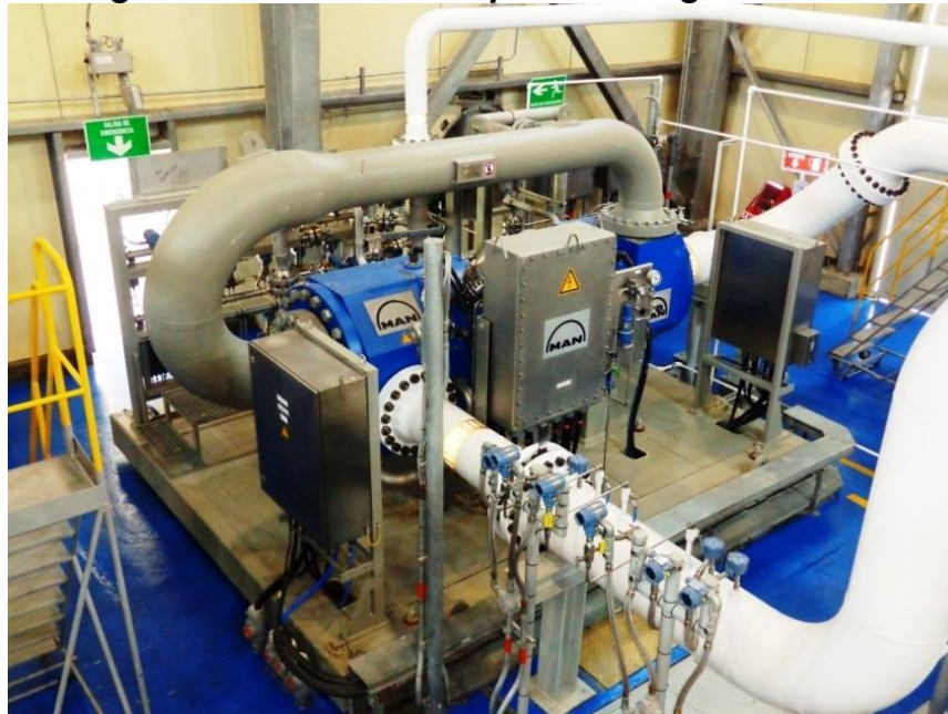
Figura 8. Unidad de compresión de gas ECGSB.
