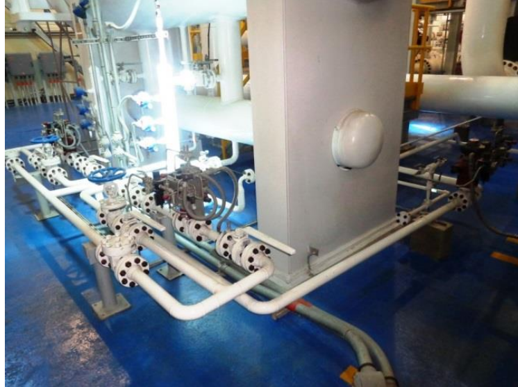
Figura 7. Sistema de drenaje líquidos condensados SB-HFS-001. ECGSB.
