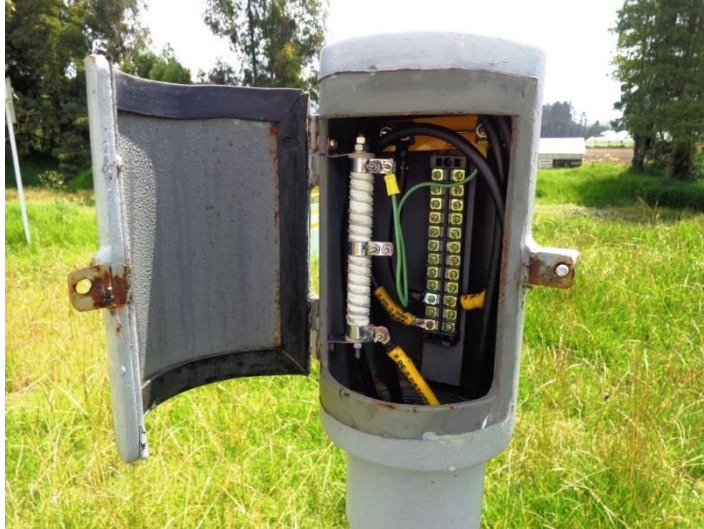
Figura 46. Estación de medición protección catódica ECGSB.
