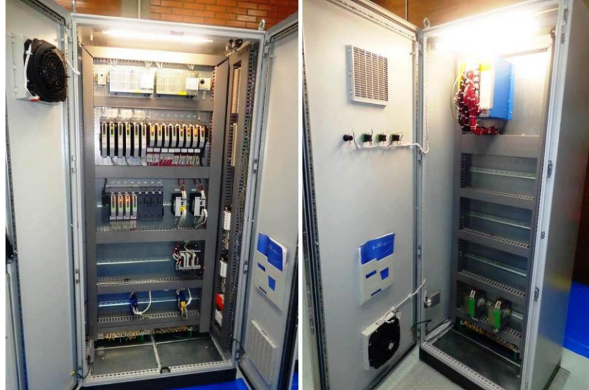
Figura 37. Tableros sistemas de control ECGSB (Izq. DCS. Der. ESD)
