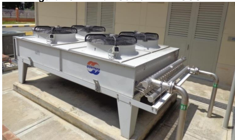
Figura 23. Fin Fan Cooler VFD ECGSB.
