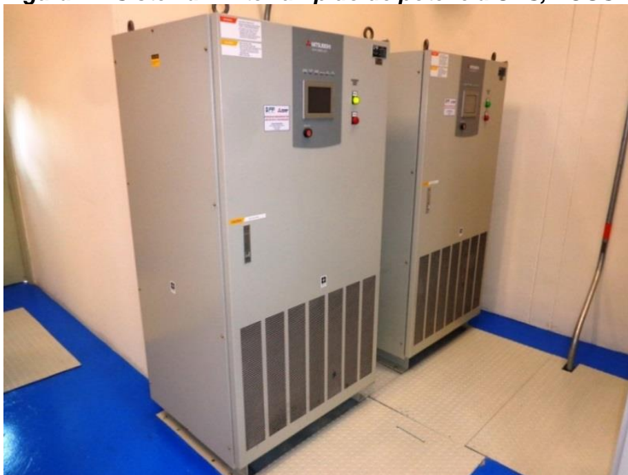
Figura 42. Sistema ininterrumpido de potencia UPS, ECGSB.
