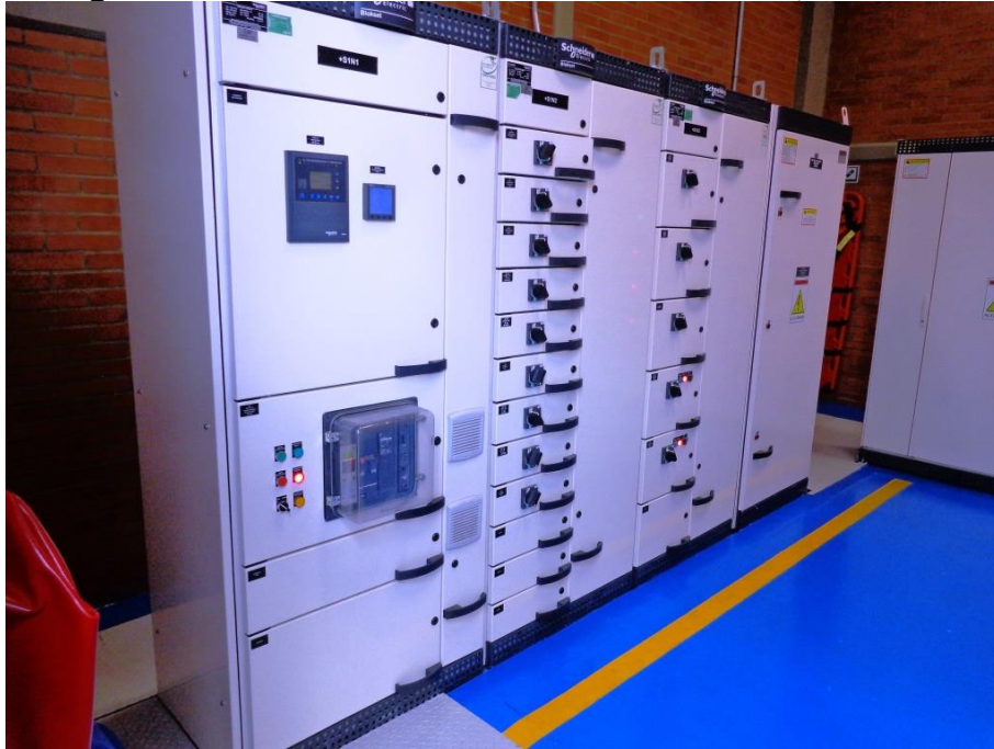
Figura 40. Tablero de distribución 480v CCM, ECGSB.
