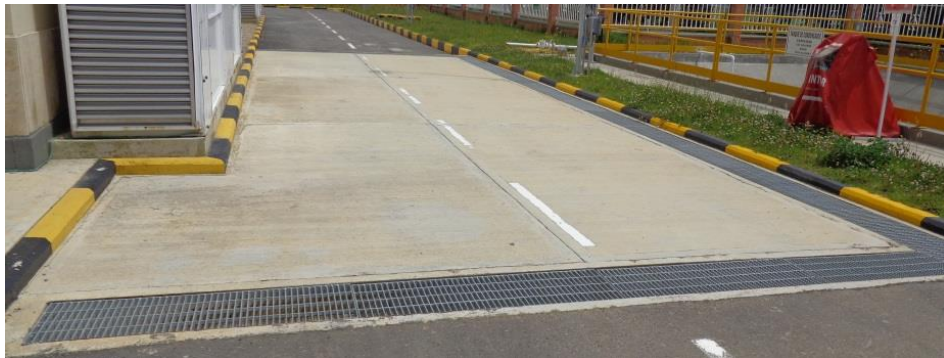
Figura 55. Cárcamos de recolección de derrames zona de carga condensados ECGSB
