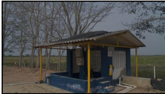
Imagen 11. Caseta de bombas – Estación Santa Lucia
