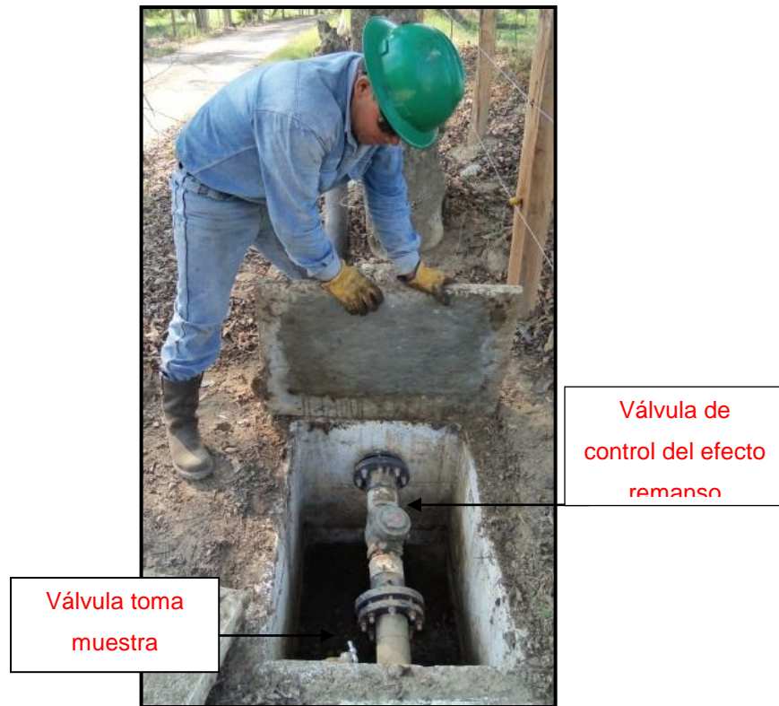
Imagen 12. Caja de inspección previa al vertimiento – Estación Santa Lucia.
