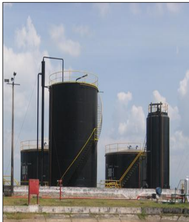
Tanques de almacenamiento
