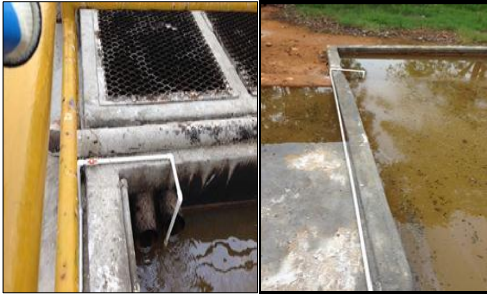
Figura 5. Facilidades de inyección de secuestrante de Bario y puntos de aplicación a la entrada de la piscina facultativa y de oxidación
