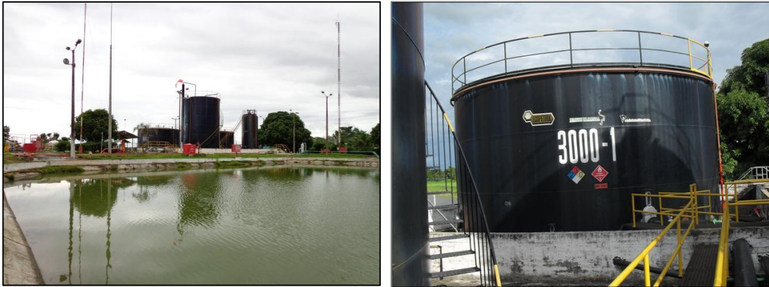
Imagen 6. Tanques de almacenamiento
