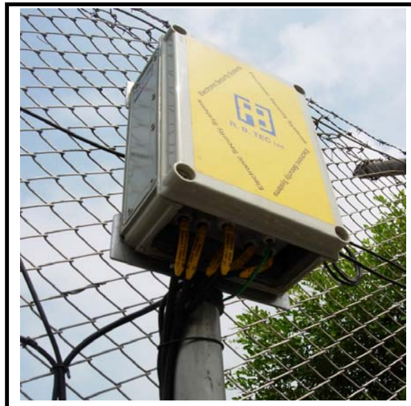
Figura 12. Unidades Controladoras Analizadoras de Campo SPU-503 (TRANSPONDERS).
