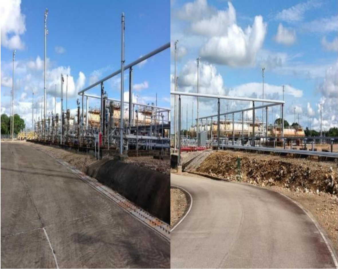
Figura 21. Balas de almacenamiento y bombas de transferencia de GLP. Fuente: Operaciones planta Cusiana Equion.
