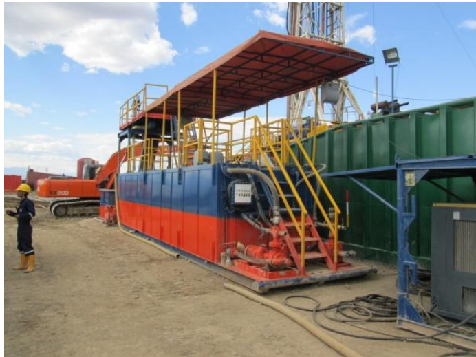
Figura 12: Unidad de Dewatering
