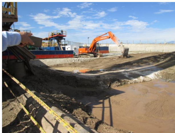
Figura 18: Piscinas de confinamiento
