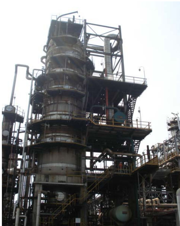
Foto 1 Torre de Destilación al Vacío T-131
