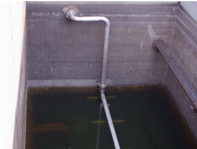
Figura 14. Nuevo aireador instalado en el Diapac.
