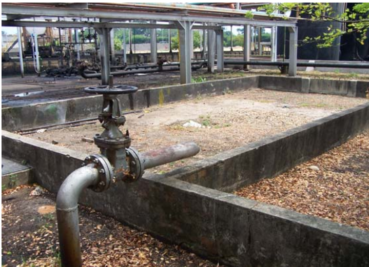
Figura 7. Las celdas de secado de lodos.
