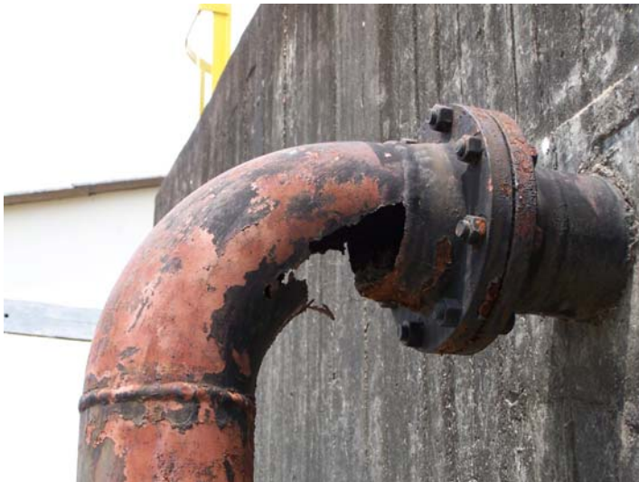
Figura 5. Tubería efluente del sistema de lodos y retorno a la obra de llegada
