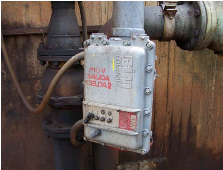
Figura 2. Válvulas Motorizadas MOV'S (automáticas):
