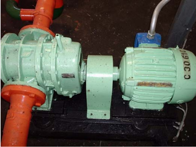
Figura 4. Figura de compresores C-3061 ABC
