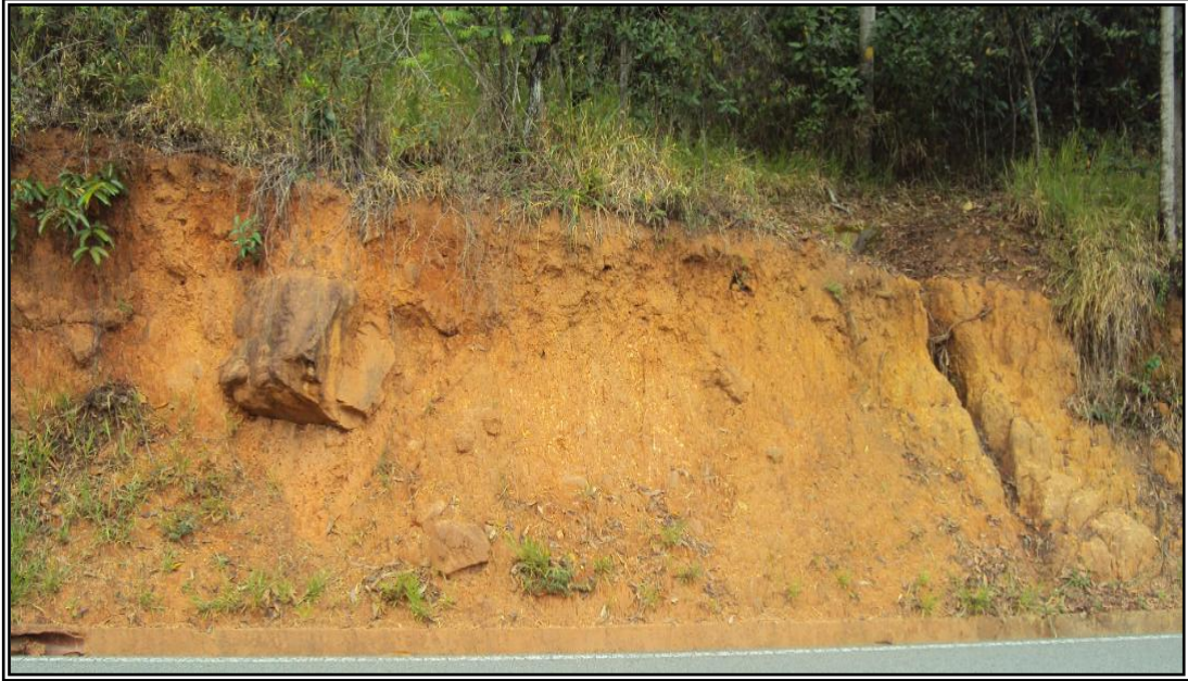
Figura 8. Descargas de aguas directamente a los taludes Fuente: Propia
