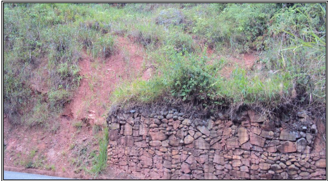
Figura 9. Desplazamientos de gaviones existentes Fuente: Propia
