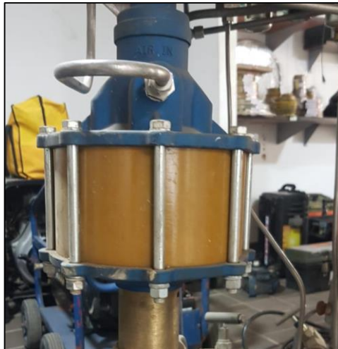
Figura 20. Bomba hidroneumática baja presión
