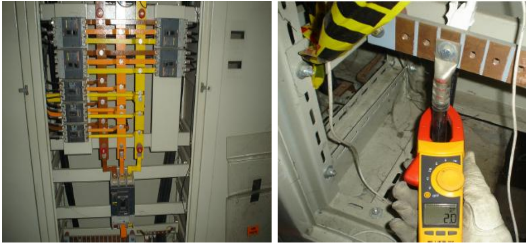
FIGURA 57. Tablero General de Distribución (Subestación N°4)
