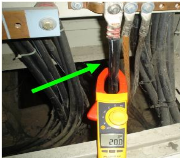
58 a. Corriente 20 Arms (tierra del tablero de Extrusora SIMA)
