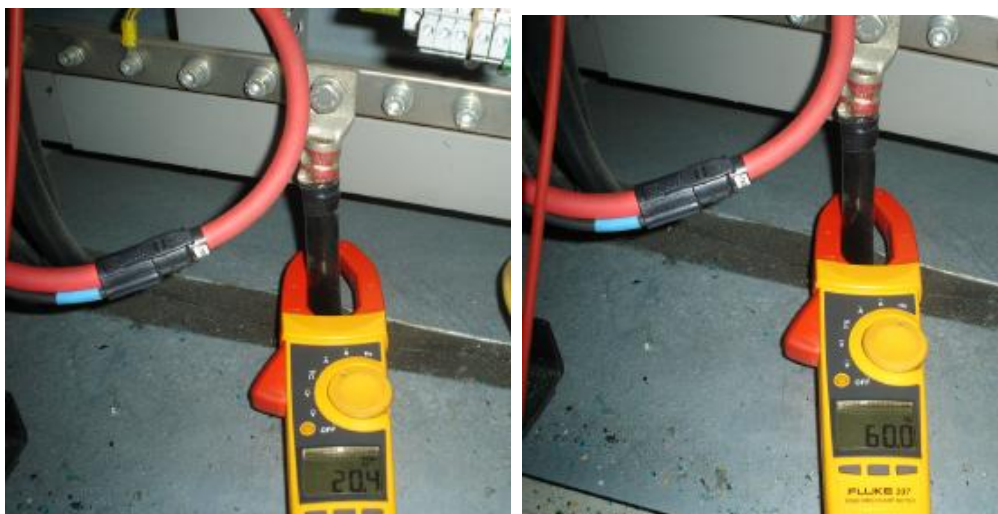
FIGURA 62. Corriente a través del conductor de puesta a tierra 20,4 Arms 60 Hz
