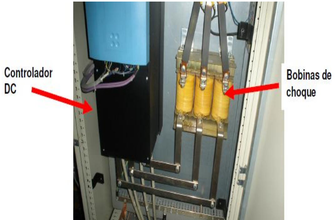
FIGURA 66. Controlador DC y bobinas de choque
