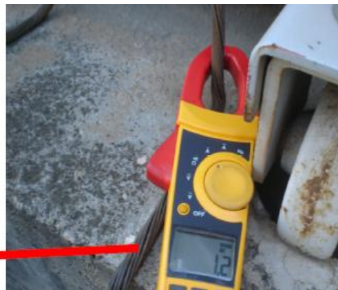
59 b. Corriente de 1,2 Arms a través del conductor de puesta a tierra
