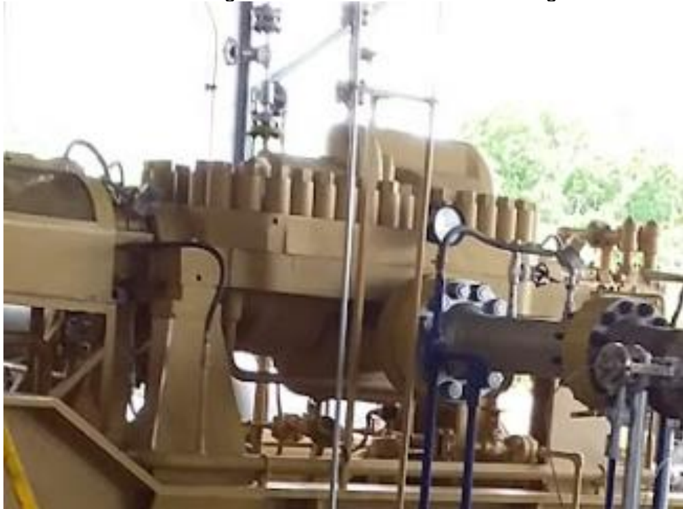
Ilustración 1. Bomba Centrífuga vista desde la línea de descarga
