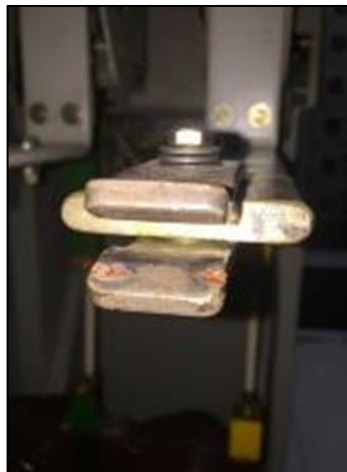
Figura 25. Contacto macho interruptor AXG901B con rastro de alta temperatura.
