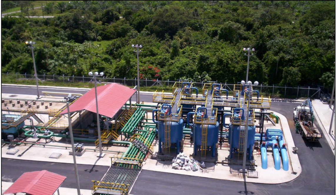
Figura 2. Estación de Tratamiento de Apiay.
