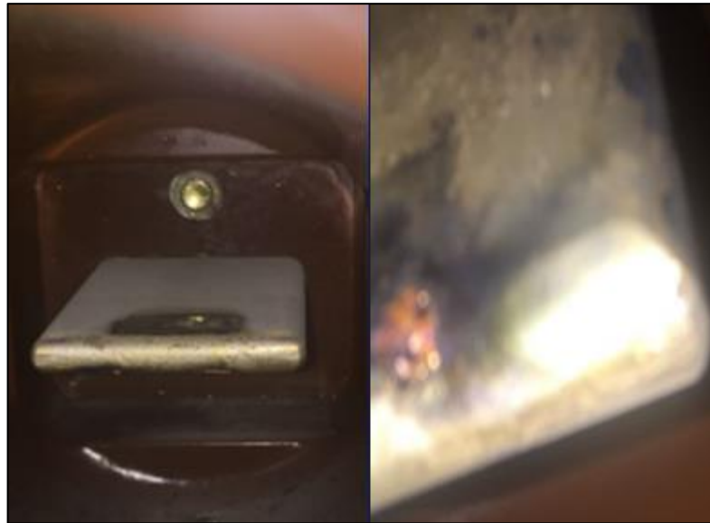
Figura 24. Contacto hembra interruptor AXG901B con rastro de alta temperatura.
