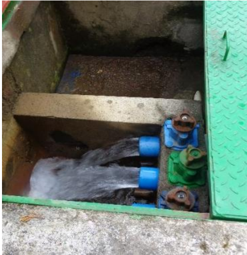
Figura 3. Cámara de aquietamiento
