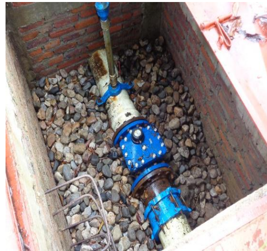
Figura 10. Macromedidor a la salida PTAP
