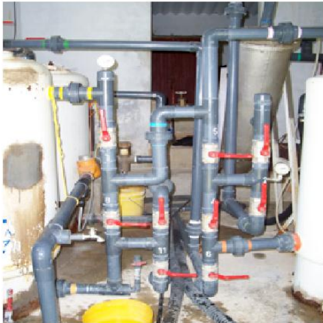
Figura 12. Elementos PTAP Ma. Auxiliadora
