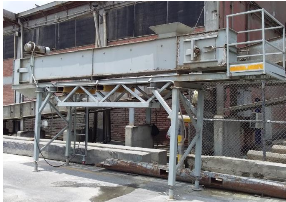
Ilustración 16. Transportador portátil de 6 metros usados en muelle 6.
