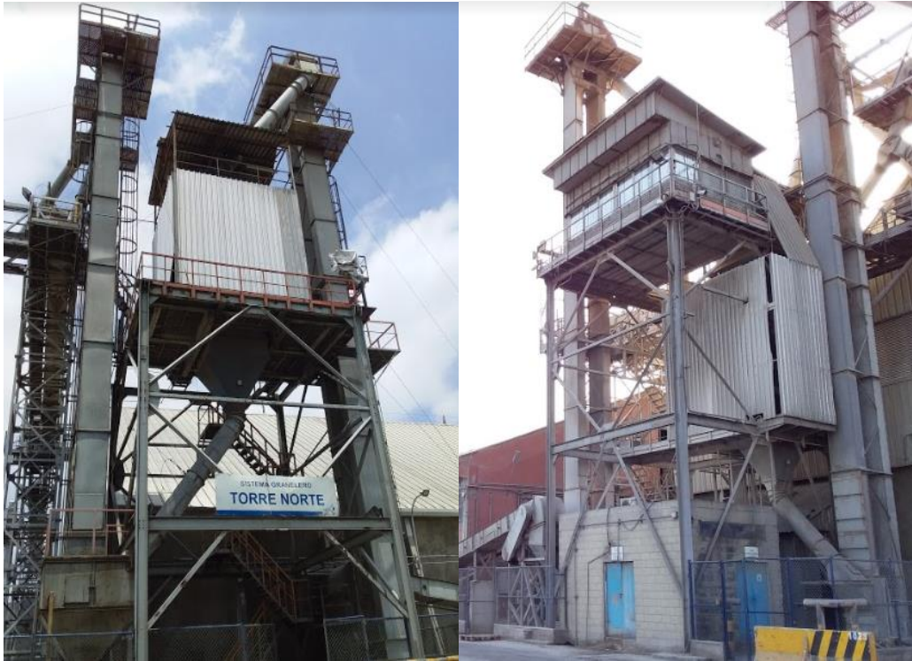
Ilustración 13. Elevadores de cangilones Torre norte y sur.
