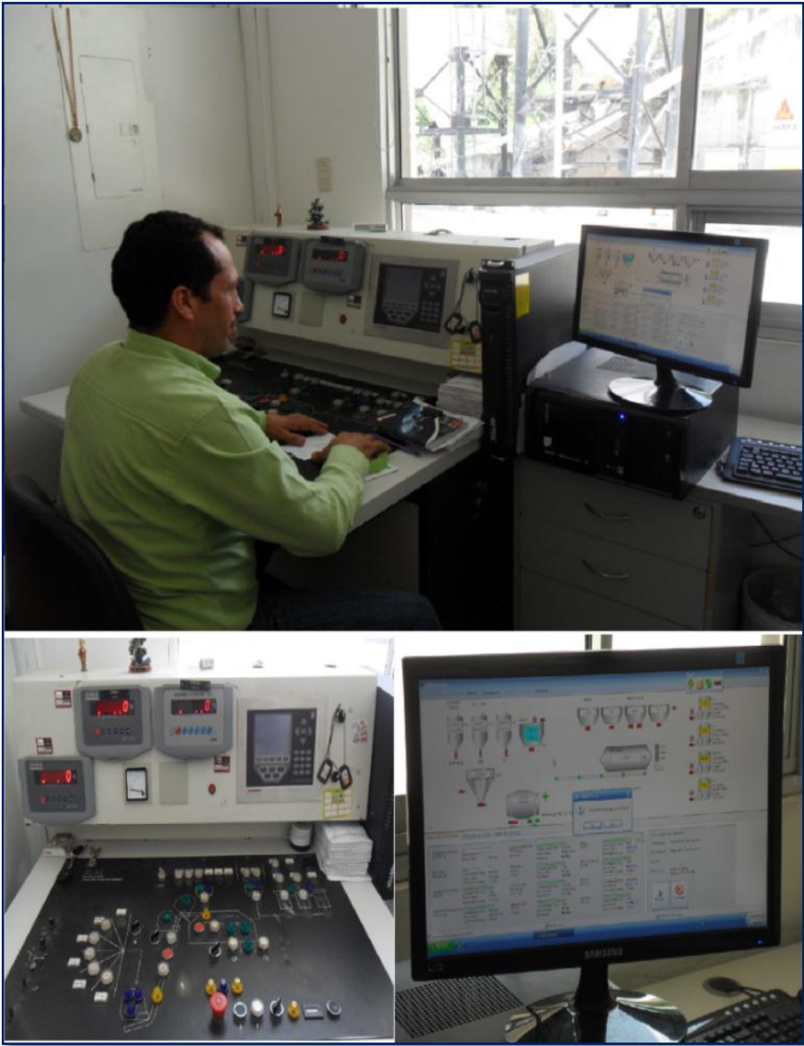
Figura 17. Centro y tablero de control
