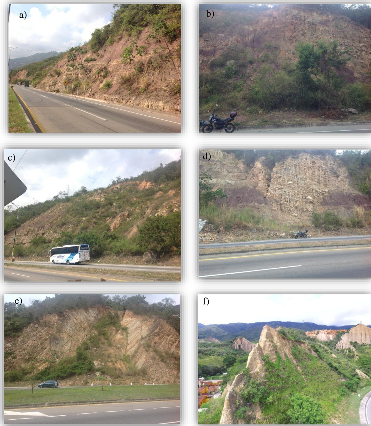
Figura 13. Geoformas del área de estudio. a) Laderas muy inclinadas. b) y c) Corona y cuerpos de movimiento en masa. d) Corte vertical de ladera, talud con alta amenaza. e) Deposito de detritos asociados a un deslizamiento rotacional en cuña. f) Laderas inclinadas y tierras malas.
