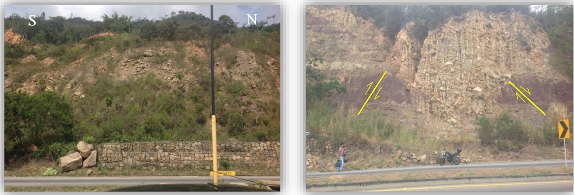
Figura 22. Izquierda a) Depósito coluvial con obras ingenieriles de control insuficientes (gaviones) unidad (Strc3). Derecha b) Depósito coluvial Sub-vertical con evidencias de planos de falla y altamente erosionado, unidad (Strc4)
