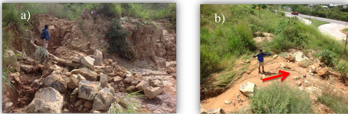
Figura 15. Flujo de detritos localizado 50m hacia el sur desde la estación AFA-9. a) Bloques y arenas lodosas transportadas por el flujo. b) Canal de flujo, el flujo llegó hasta la vía que se observa en parte superior derecha.
