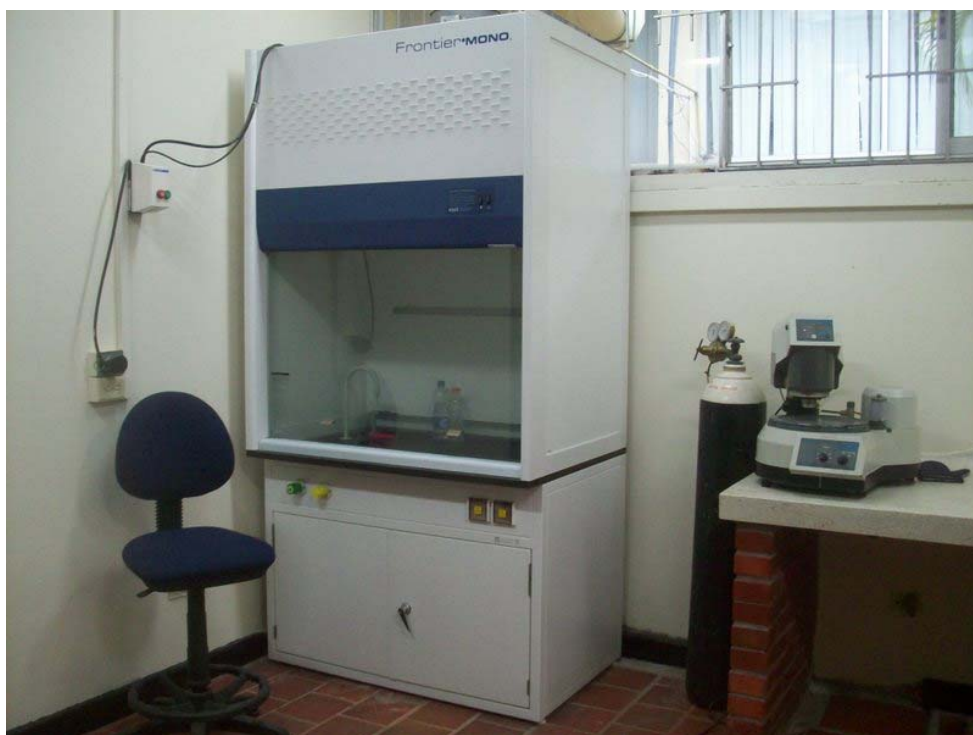
Figura 11. Cabina extractora de gases
