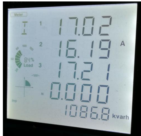
Figura 29. Acuvim IIR ubicado en el CTP4.
