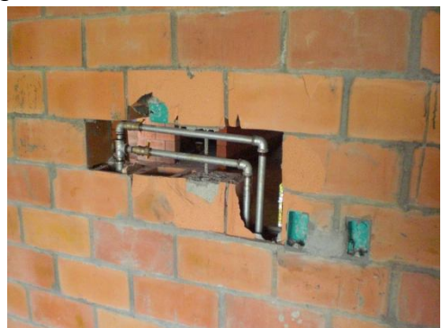
Figura 138. Instalación mal efectuada.
