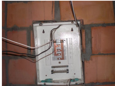
Figura 68. Tablero de distribución.
