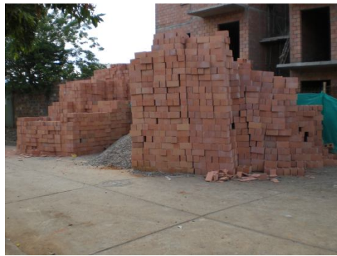
Figura 28. Bloque mal almacenado.
