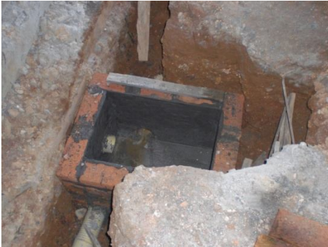
Figura 105. Caja de inspección sanitaria.
