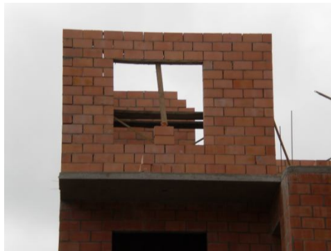
Figura 32. Muro mal construido.
