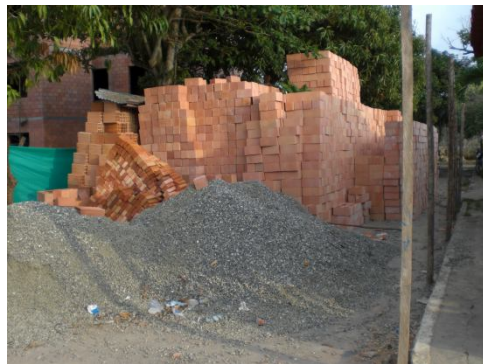
Figura 42. Bloque mal almacenado.
