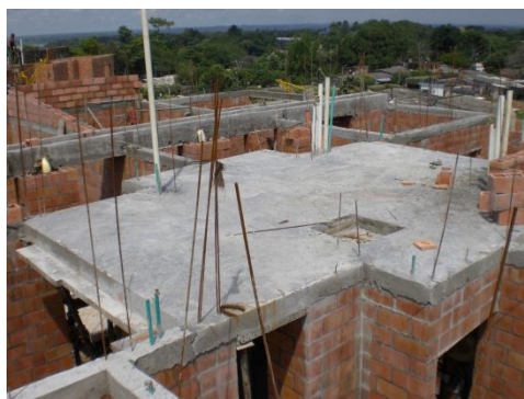
Figura 52. Placa de tanques Torre B.
