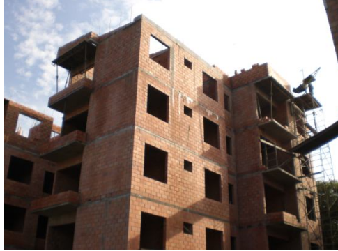
Figura 104. Torre 1 Sur con cuchillas
