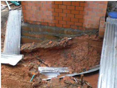
Figura 97. Deslizamiento de tierra.
