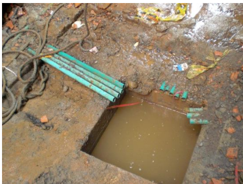
Figura 69. Caja eléctrica mal instalada.
