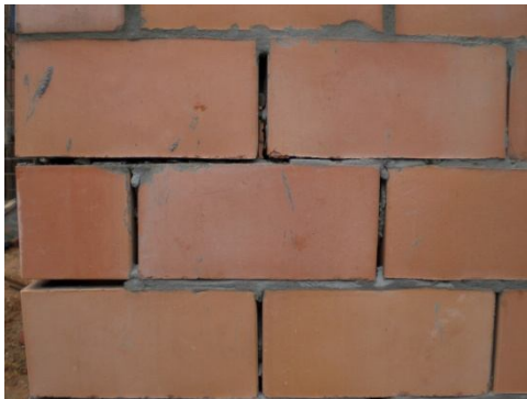
Figura 47. Muro mal construido.
