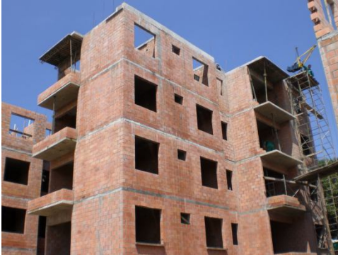
Figura 87. Estado de la Torre 1 Sur.
