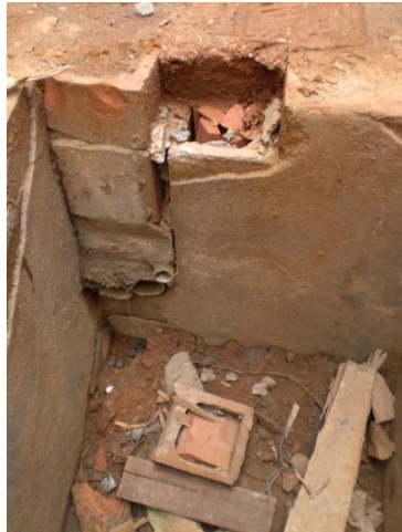
Figura 37. Caja de inspección.
