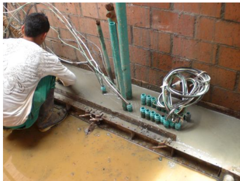
Figura 94. Base para medidores eléctricos.
