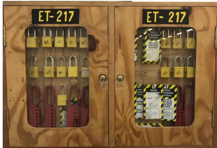
Figura 17 Candados y etiquetas de la subestación ET-217.
