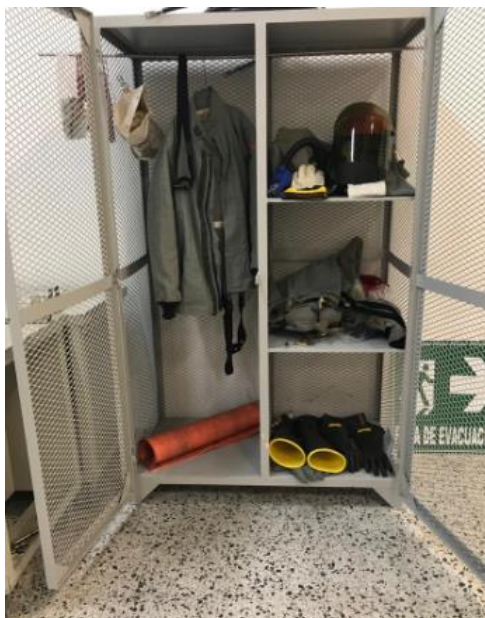
Figura 18 Elementos de protección personal subestación ET-217.
