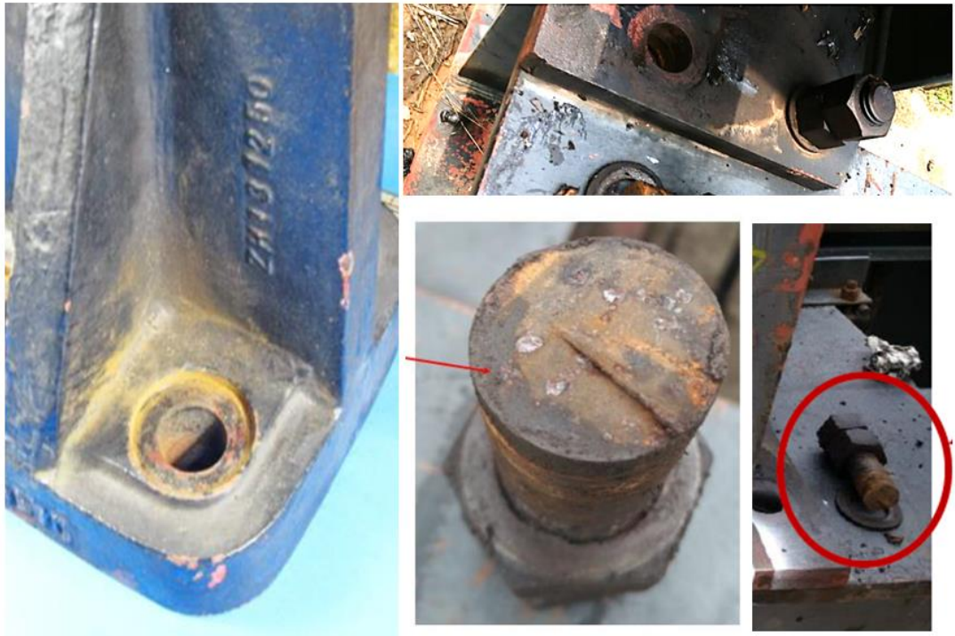
Ilustración 10. Elementos de sujeción fracturados y faltantes.
