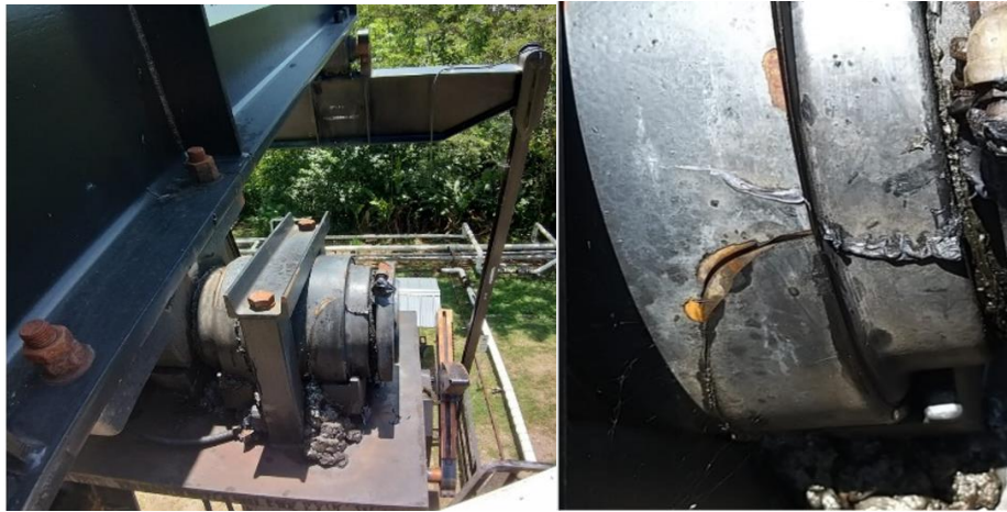
Ilustración 7. Evidencia de agrietamiento
