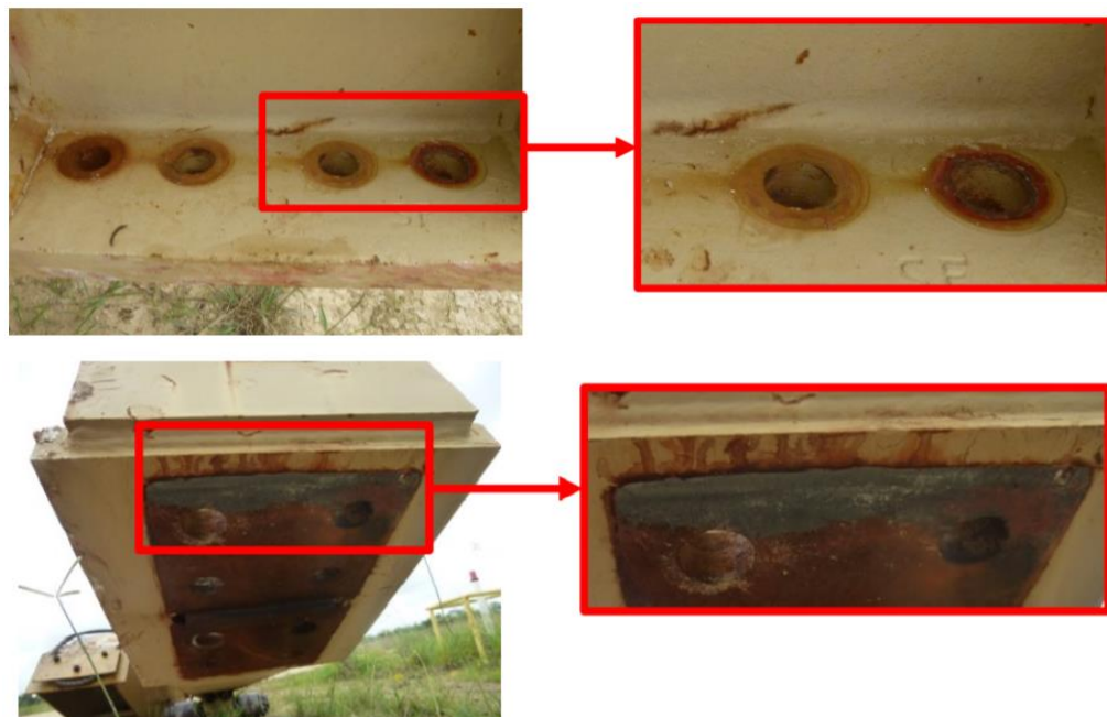
Ilustración 8. Evidencia de herrumbre
