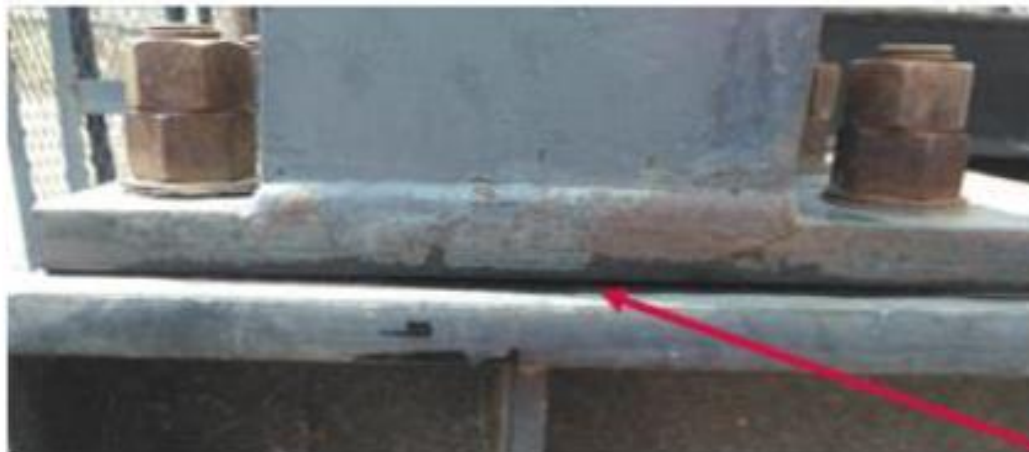
Ilustración 15 Deformación en zona de acople
